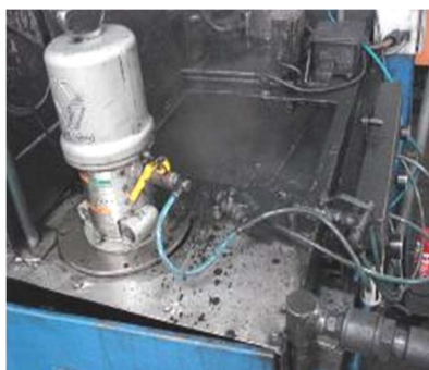
a) Tanque de lubrificante
