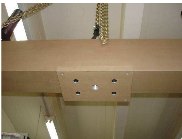
Figura 3.46 – Placa de conexão do cilindro pneumático aparafusada à viga superior
