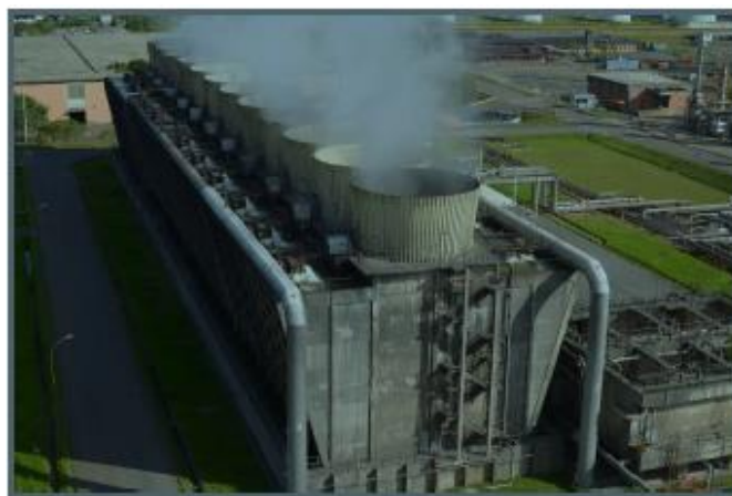
Figura 3-1 Torre de resfriamento estudada (Fonte: BRASKEM, 2016)
