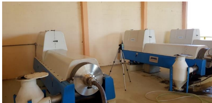
Figura 4.6 – Centrífugas da Desidratação (Foto do autor).
