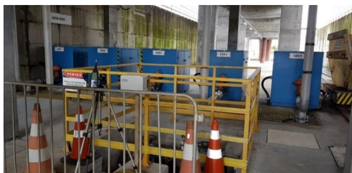
Figura 4.3 – Reservatório em frente aos Sopradores (Foto do autor).
