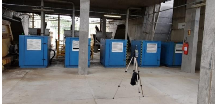
Figura 4.4 – Parte de trás dos Sopradores (Foto do autor).
