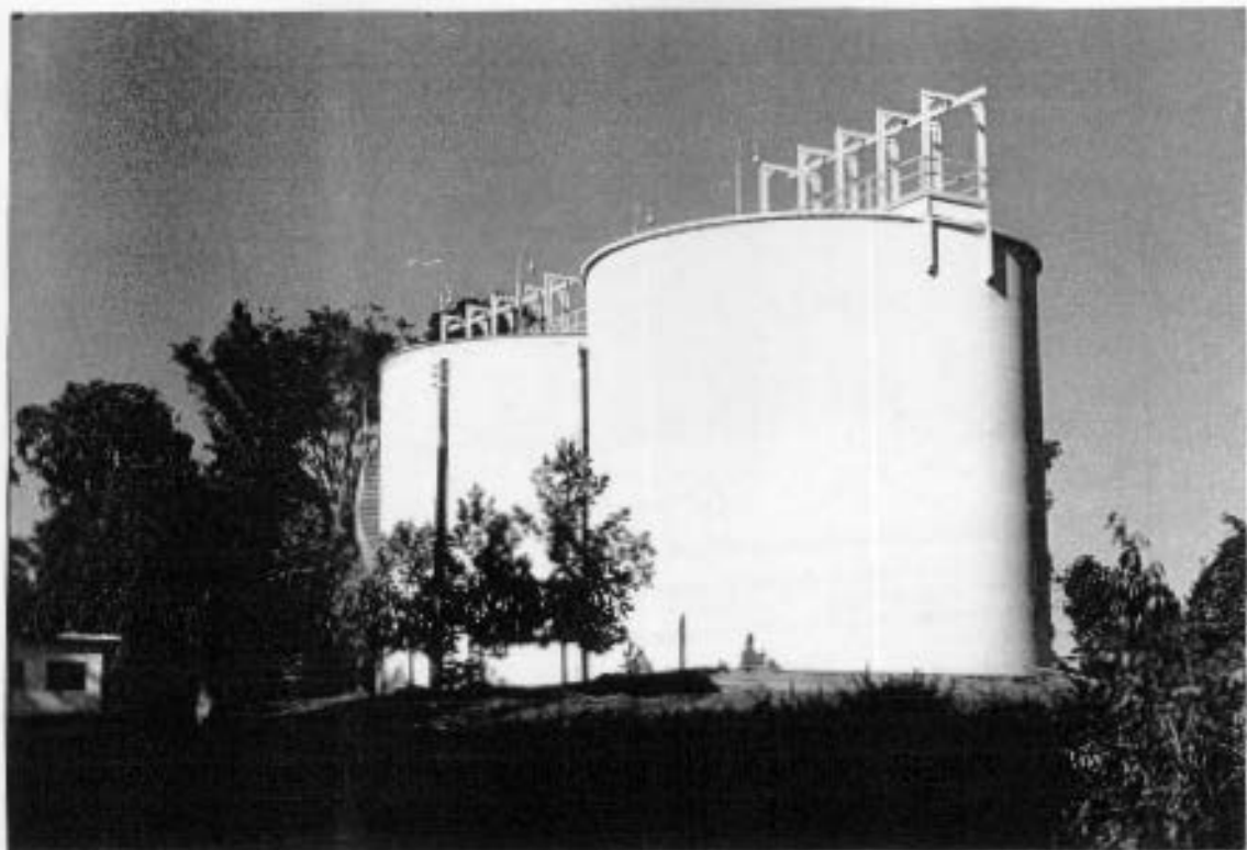
FOTO 12. TANQUES DE ESTOCAGEM DE PRODUTO NA MINA
