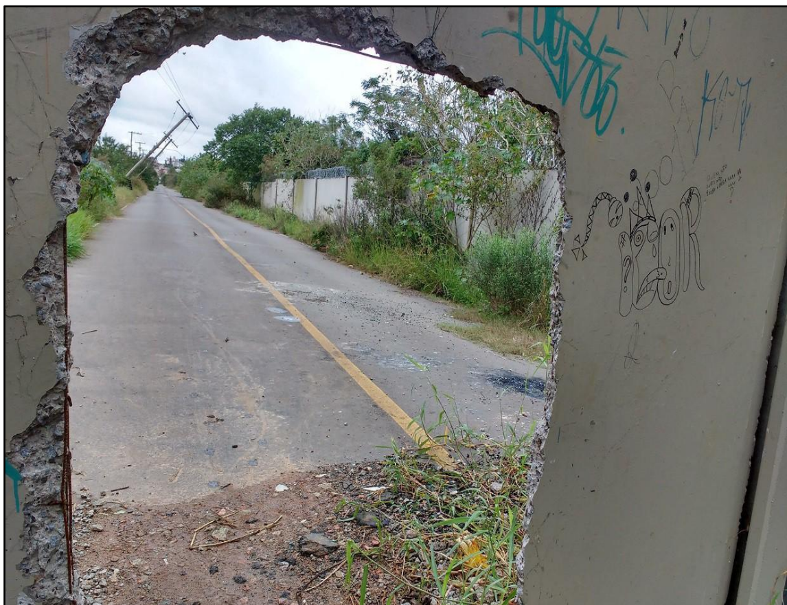
Figura 38. Buraco no muro que cerca a área cedida ao aeroporto e bloqueia a Av. Dique.
