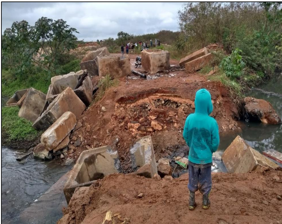
Figura 39. Pontilhão destruído para evitar a passagem.
