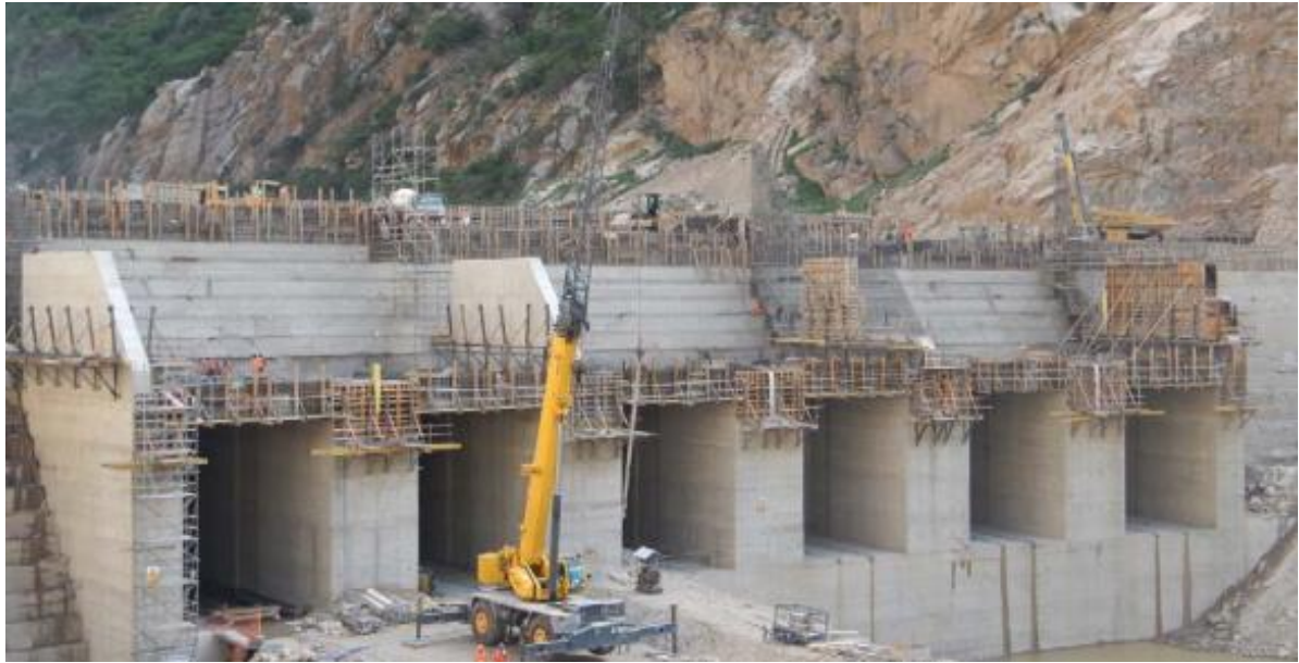
Figura 1 – Descarregadores de fundo instalados na represa Cerro del Águila
