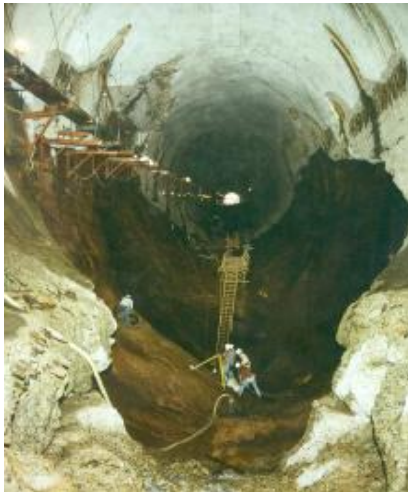
Figura 17 - Barragem de Glen Canyon, túnel do vertedouro esquerdo, setembro de 1983, buraco com 11 metros de profundidade
