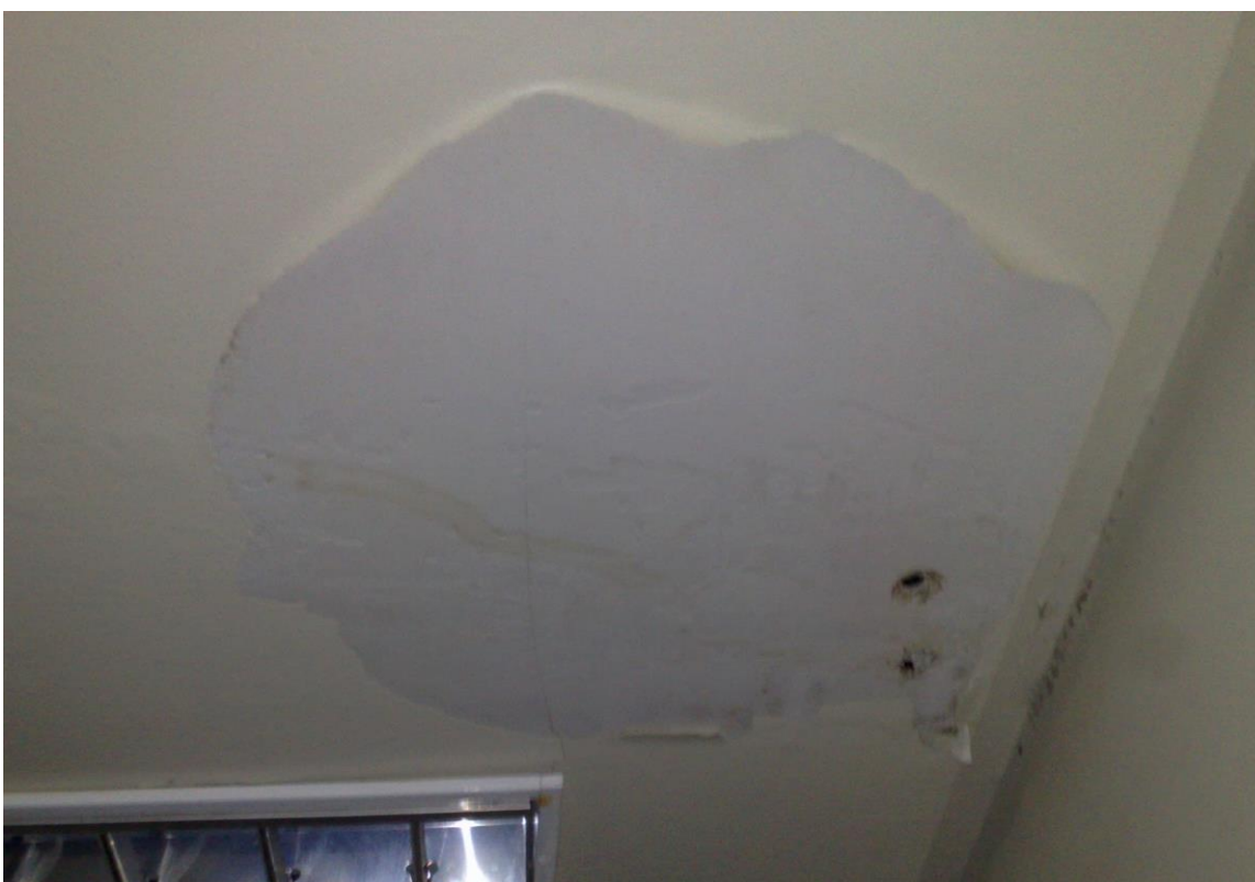
Figura 9 – Forro danificado por umidade no auditório do térreo.
