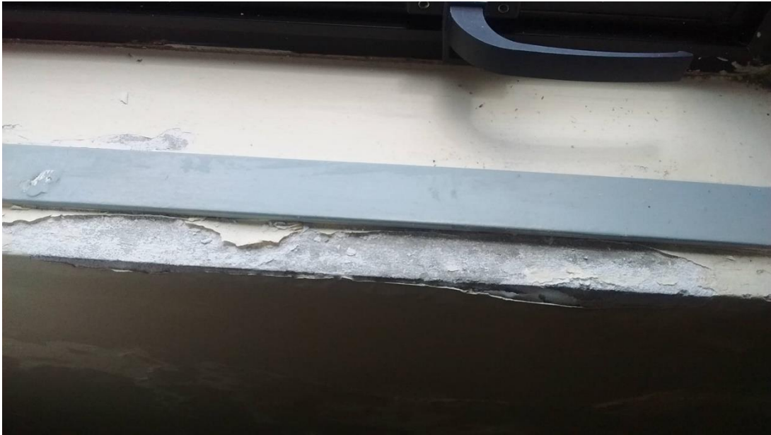
Figura 48 – Peitoril danificado pela umidade.
