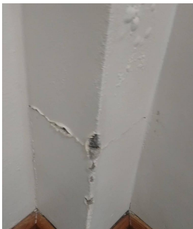
Figura 34 – Shaft deteriorado pela umidade.
