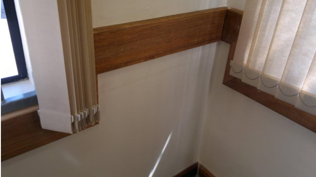
Figura 17 – Umidade ascendente sobre a região impermeabilizada.
