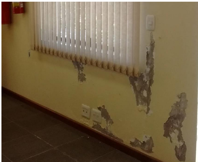
Figura 24 – Infiltração pela esquadria e pela fachada.
