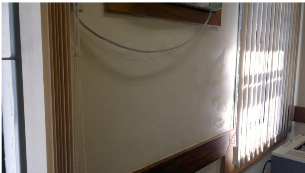
Figura 19 – Umidade na parede sob o vão do condicionador de ar.
