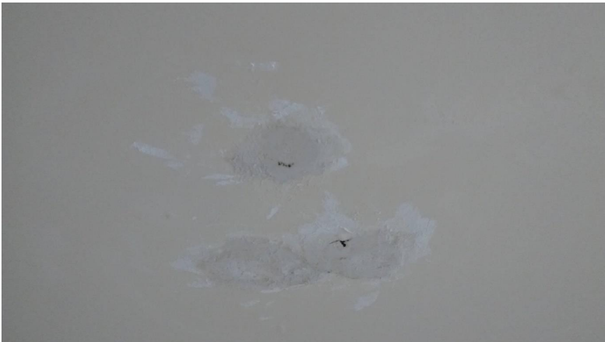
Figura 16 – Infiltração no forro de gesso da secretaria.
