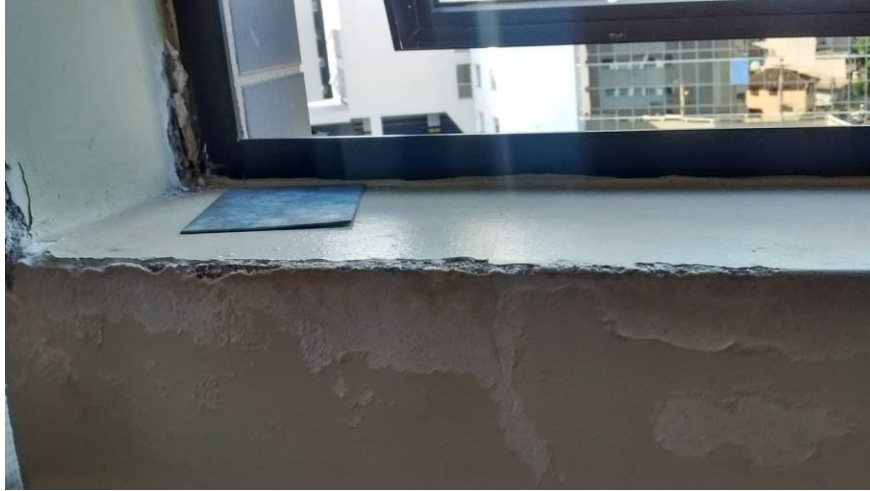
Figura 12 – Revestimento danificado pela falha na estanqueidade da esquadria.
