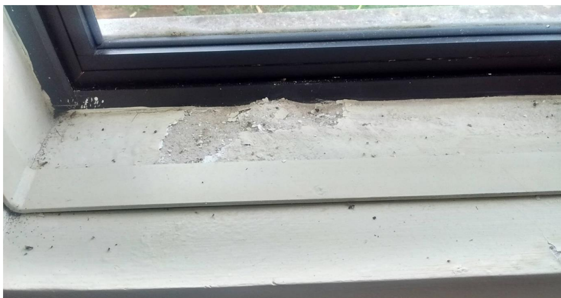
Figura 32 – Infiltração no peitoril da esquadria.
