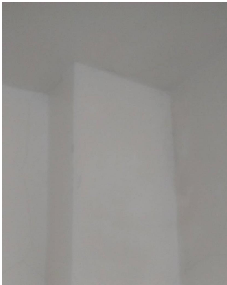
Figura 50 – Shaft danificado pela umidade.
