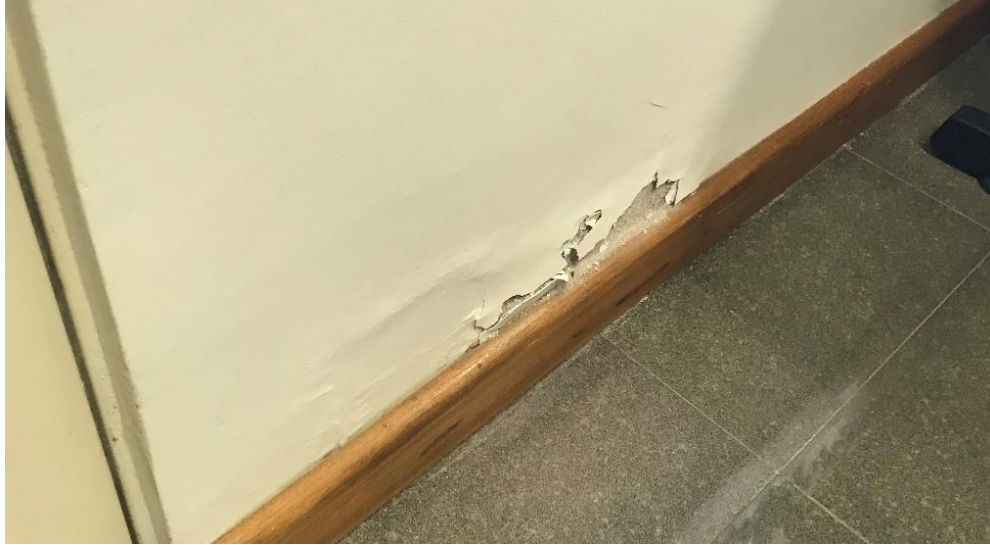
Figura 43 – Parede com bolhas e rodapé danificado pela umidade.
