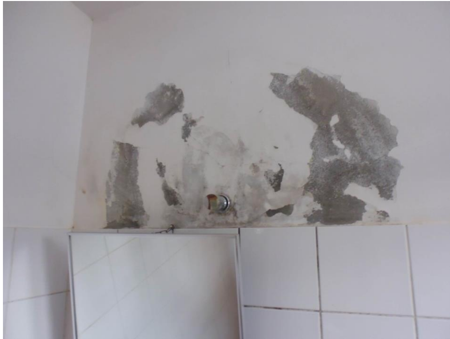
Figura 3 – Ilustração da infiltração causada por registro danificado.
