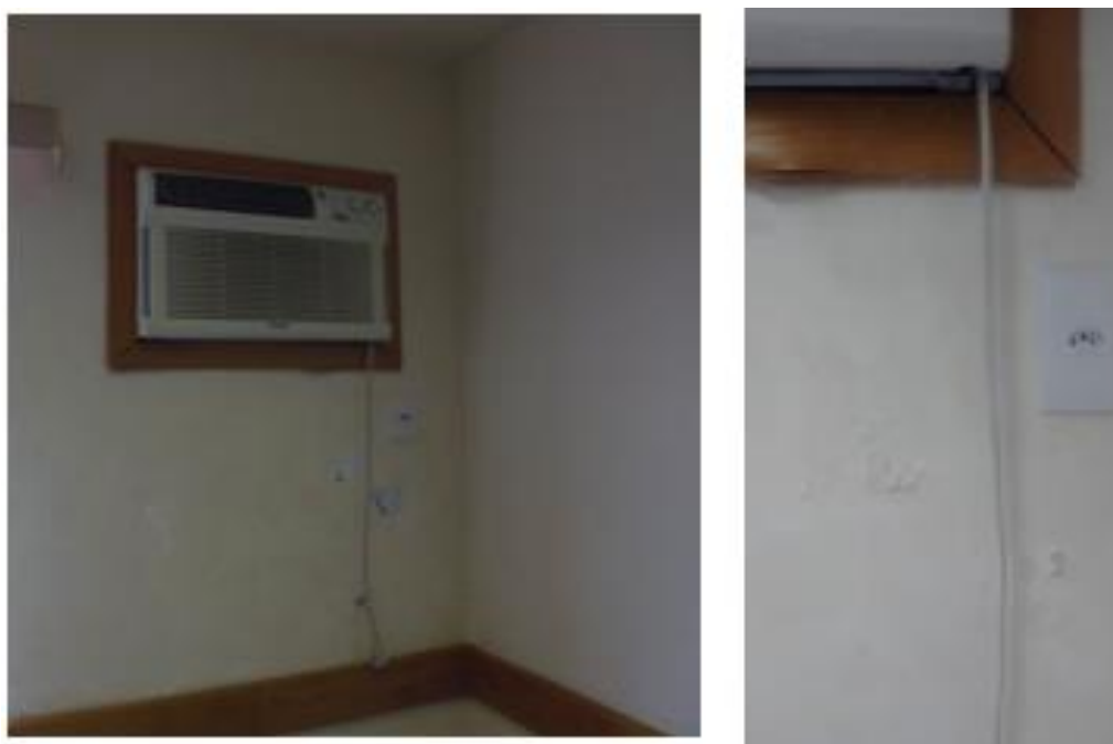
Figura 6A e Figura 6B – Falha de estanqueidade no vão do ar condicionado.
