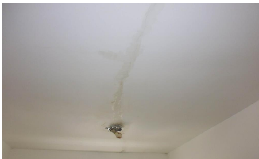
Figura 8 – Fissura e infiltração na laje.
