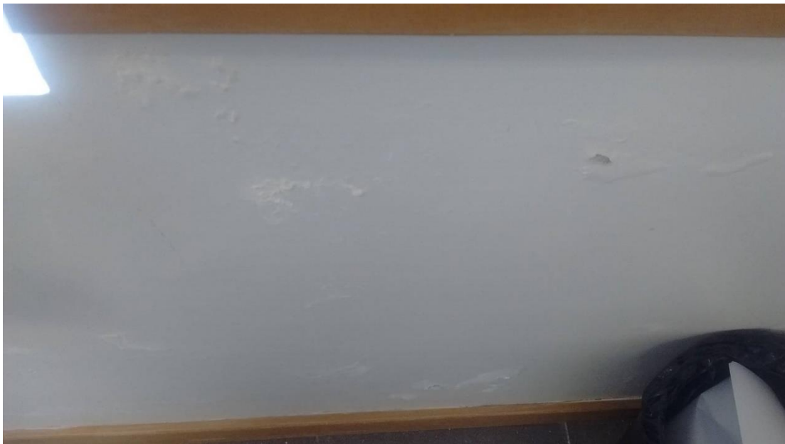
Figura 49 – Parede com bolhas e manchas causadas pela umidade.
