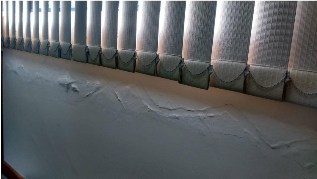
Figura 21 – Umidade na parede por infiltração pela esquadria.
