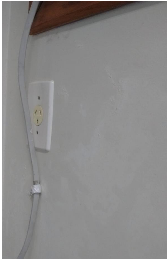
Figura 13 – Manchas de umidade na parede abaixo da abertura do ar condicionado.
