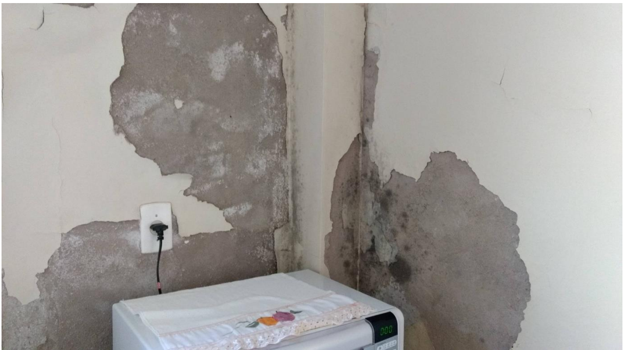
Figura 54 – Revestimento da parede danificada pela umidade.
