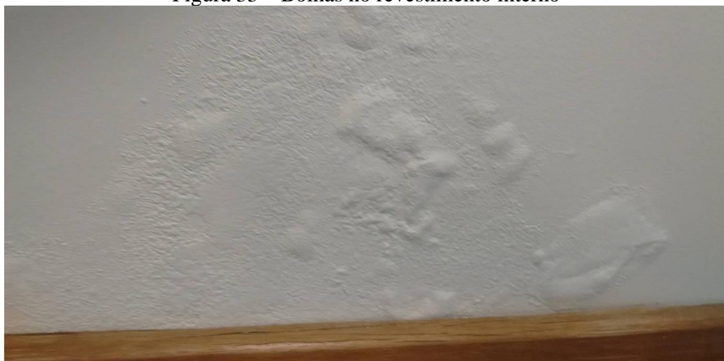
Figura 33 – Bolhas no revestimento interno
