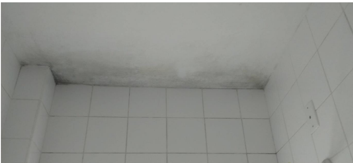
Figura 35 – Infiltração e mofo na laje do sanitário.
