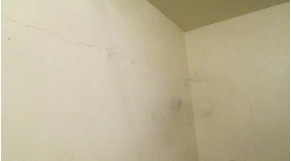
Figura 41 – Parede com fissura horizontal e manchas de umidade.
