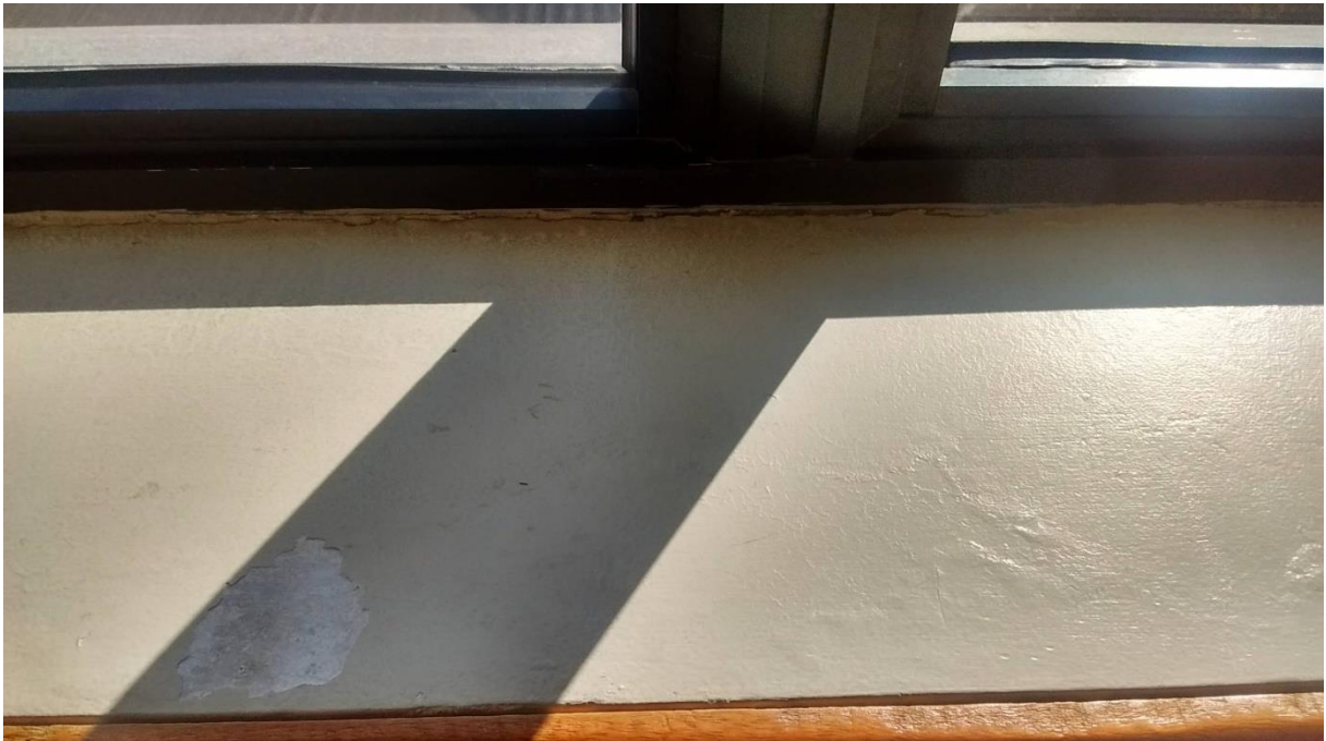
Figura 11 – Vedação da esquadria danificada.
