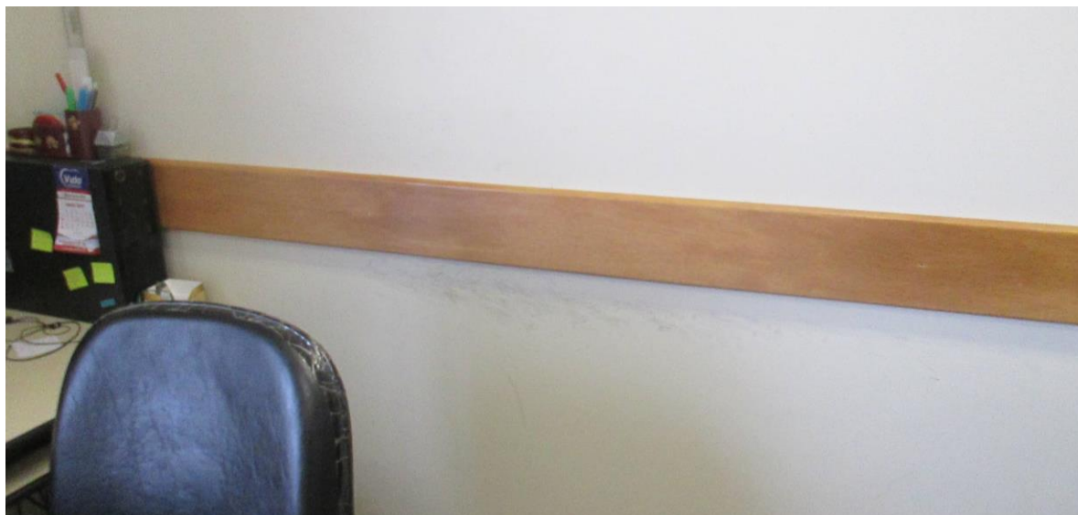
Figura 30 – Rodameio danificado pela presença de umidade.
