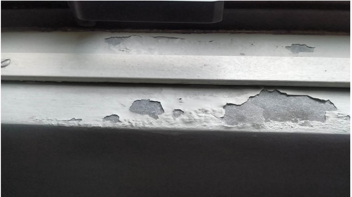
Figura 56 – Peitoril danificado pela umidade.
