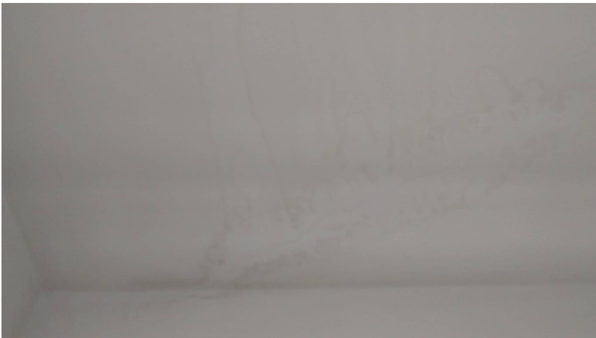
Figura 55 – Mancha de umidade na laje da recepção.
