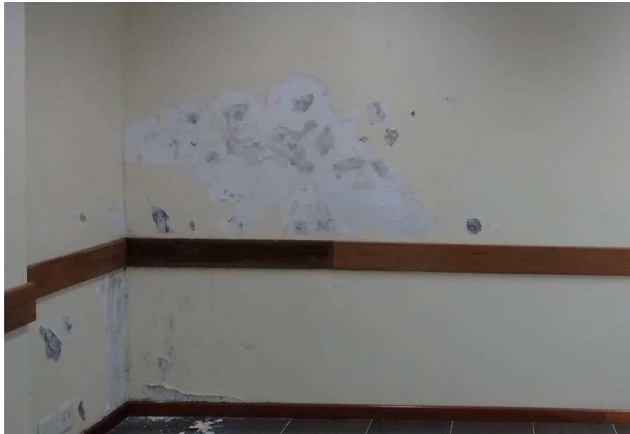
Figura 23 – Parede e rodameio danificados pela umidade.
