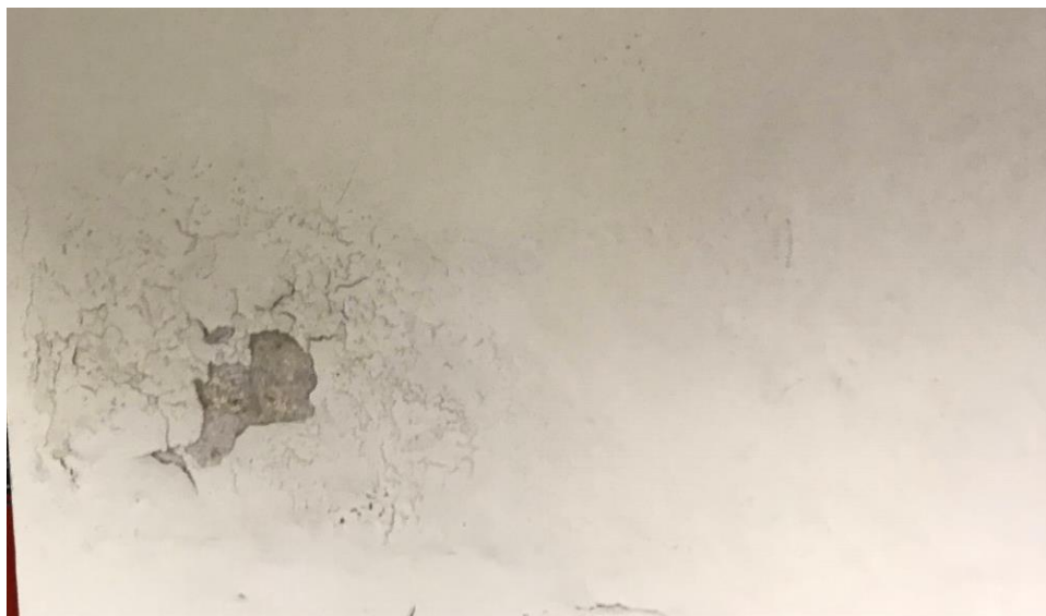
Figura 44 – Parede danificada pela umidade.
