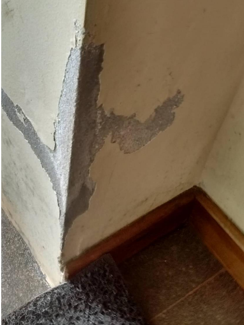
Figura 51 – Parede e rodapé com presença de umidade ascensional.
