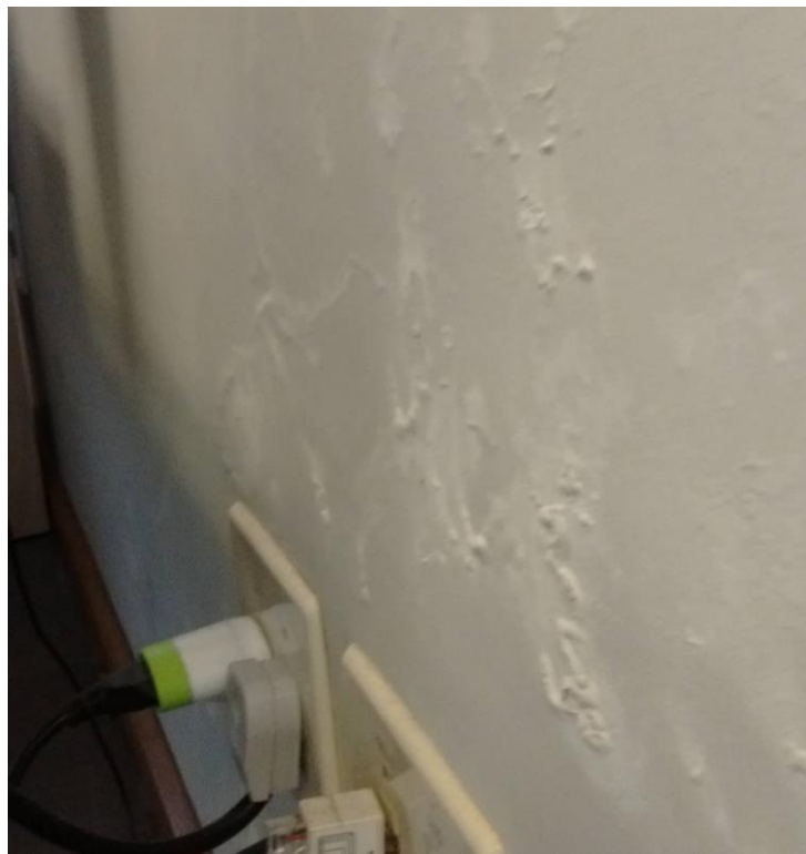
Figura 15 – Bolhas de umidade próximas das instalações elétricas.
