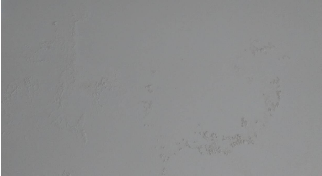
Figura 14 – Manchas e bolhas nas paredes internas.
