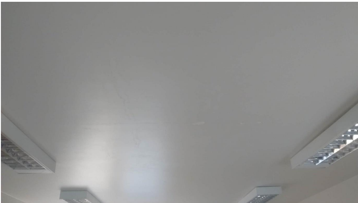
Figura 58 – Forro com trincas e bolhas, pela presença de umidade.
