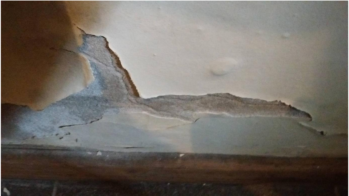
Figura 39 – Umidade ascensional no rodapé.
