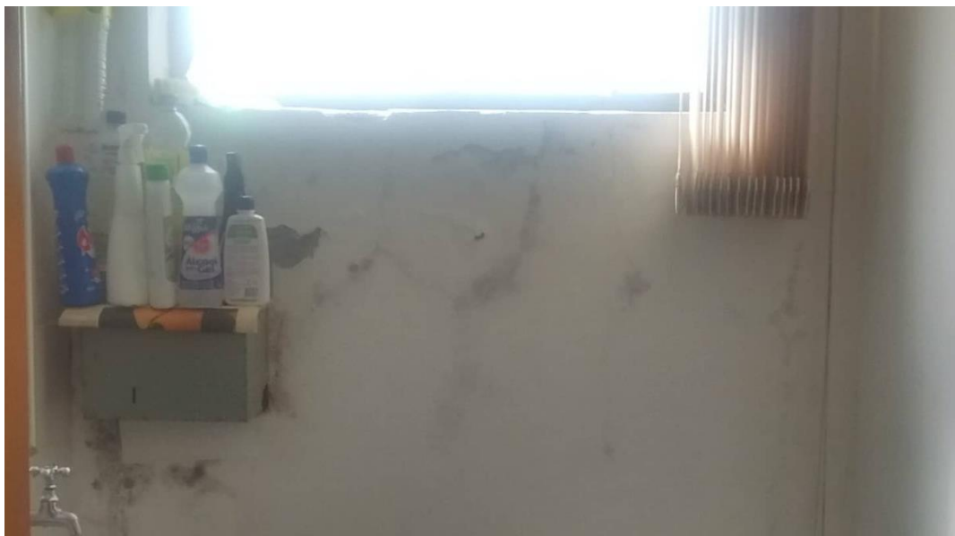
Figura 22 – Parede do sanitário de serviço danificada pela umidade.
