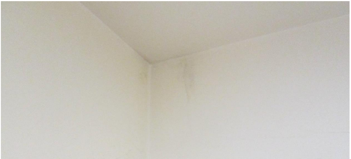
Figura 42 – Infiltração da laje da cobertura.
