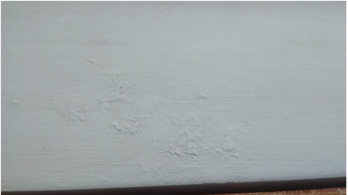
Figura 57 – Parede com presença de bolhas pela umidade.
