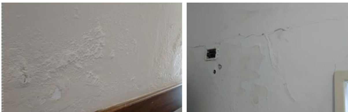
Figura 20A e Figura 20B – Revestimento danificado pela umidade.
