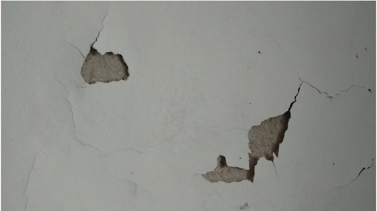
Figura 53 – Revestimento da parede danificada pela umidade.
