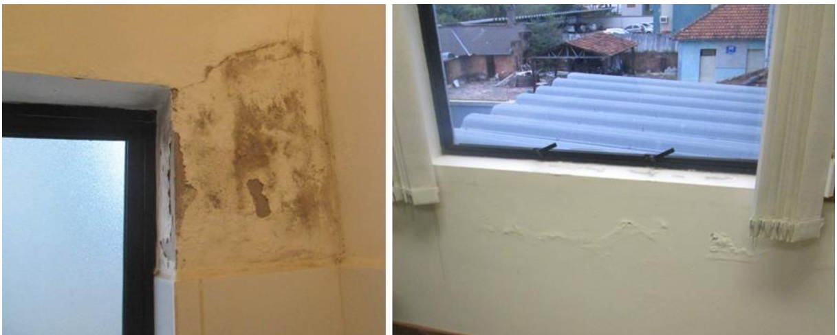
Figura 40A e Figura 40B – Infiltração por falha de estanqueidade.
