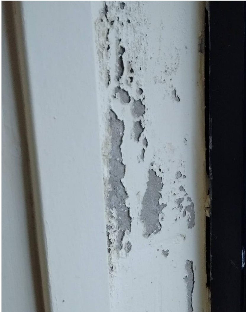
Figura 52 – Revestimento danificado no entorno da esquadria.
