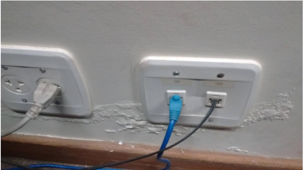
Figura 28 – Bolhas causadas pela umidade ascensional.
