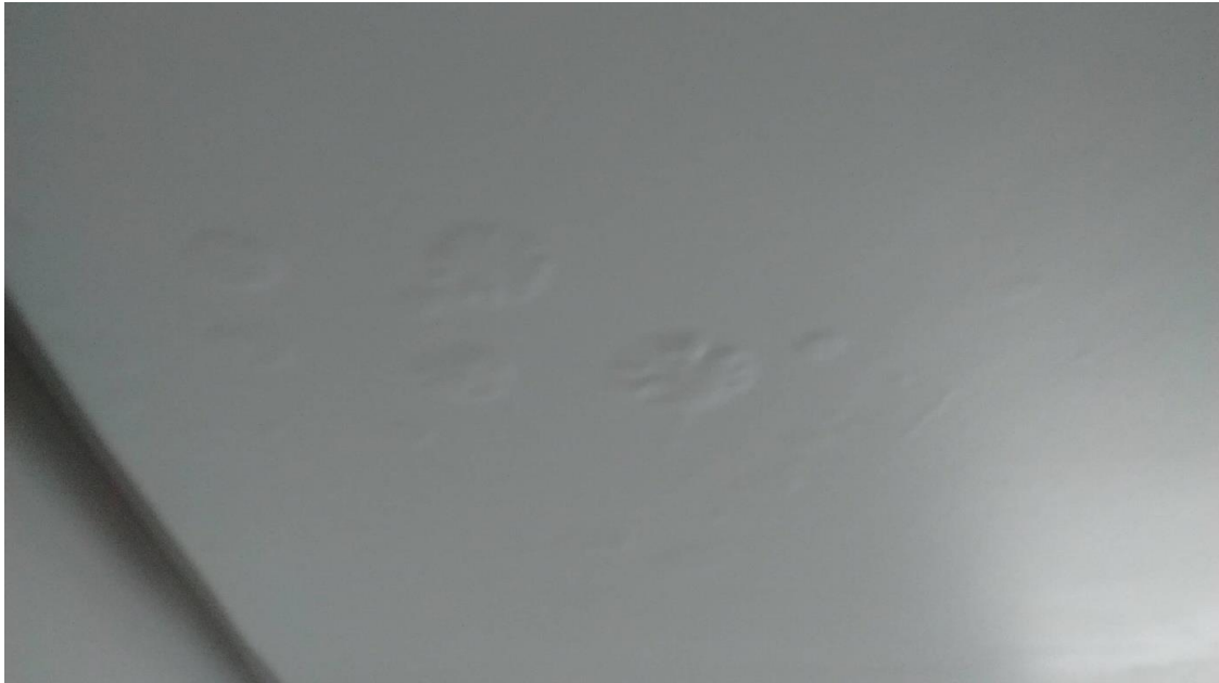
Figura 10 – Forro danificado por umidade no sanitário masculino do segundo pavimento.
