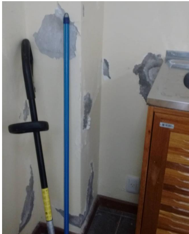
Figura 26 – Shaft danificado pela umidade.
