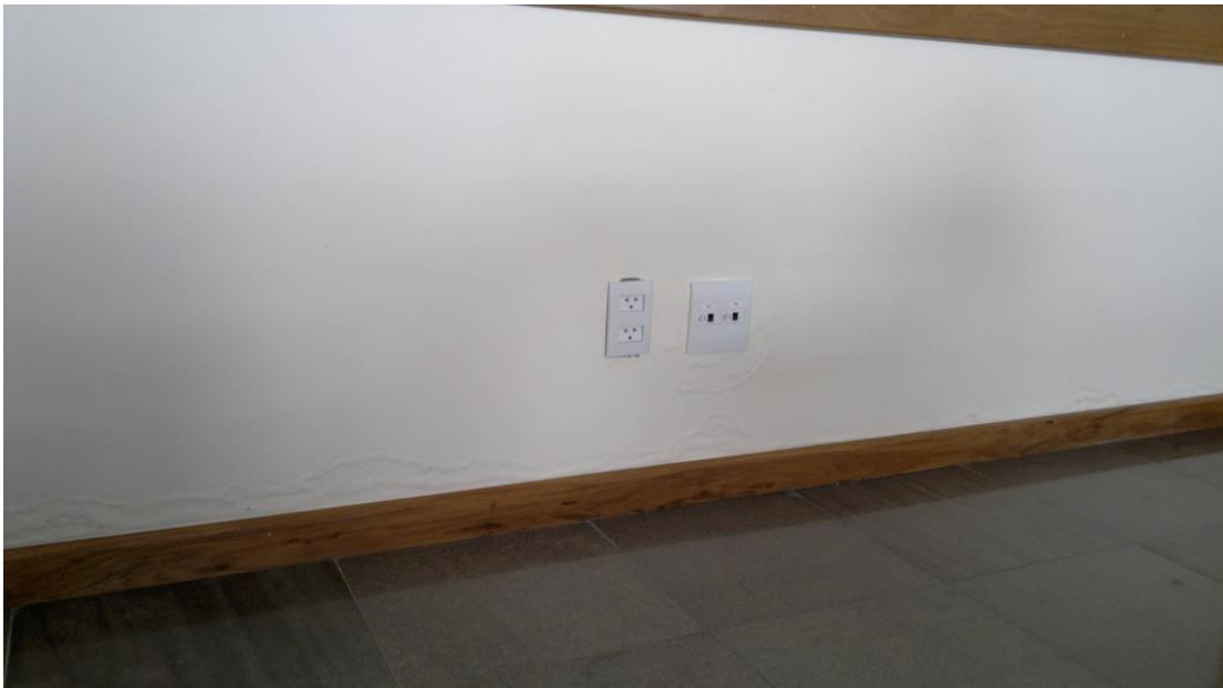
Figura 18 – Rodapé, parede e pontos elétricos afetados pela umidade.
