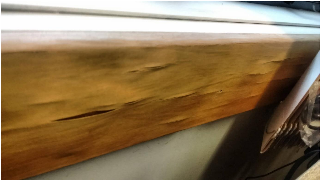
Figura 29 – Rodameio danificado pela presença de umidade.
