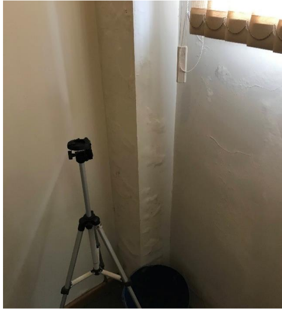
Figura 45 – Shaft danificada pela umidade.
