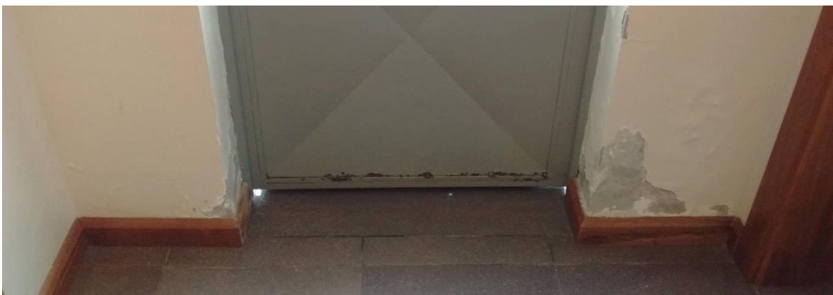
Figura 31 – Parede danificada pela presença de umidade.
