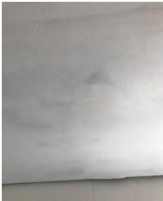
Figura 46 – Forro do sanitário com manchas de umidade.
