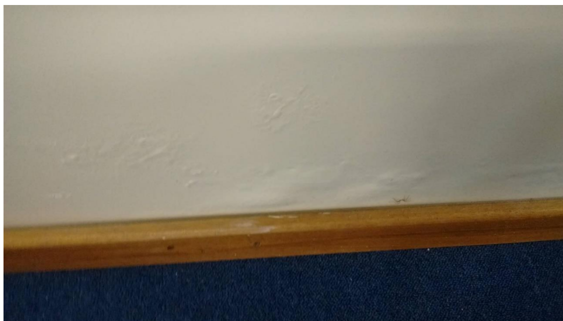
Figura 47 – Parede com bolhas e rodapé danificado pela umidade.
