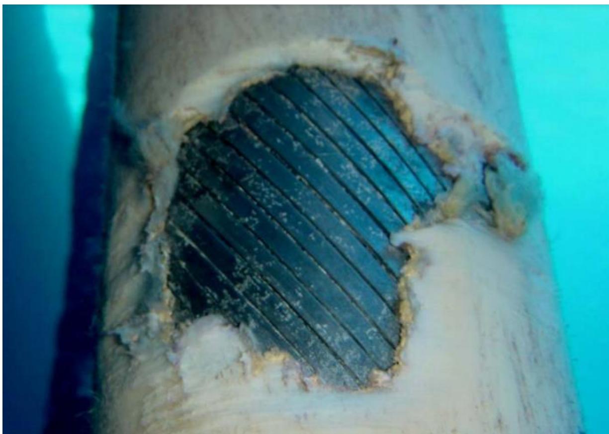
Figura 4 - Dano em capa polimérica externa causado pelo contato com braço de plataforma.
