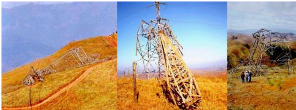
Figura 1-1 – Estruturas da linha de transmissão de 500 kV ANCH de FURNAS, próximo à cidade de Cachoeira Paulista (SP), danificadas em 22/07/2000, (LIMA e MENEZES, 2004).
