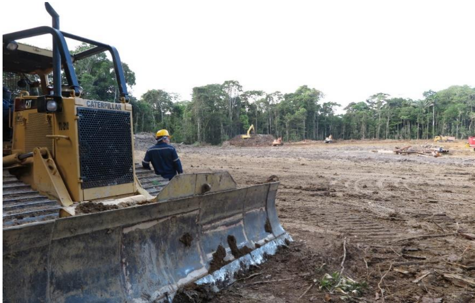
Figura 32: Desmatamento na plataforma Tambococha (não previsto no EIA), em novembro de 2018.
