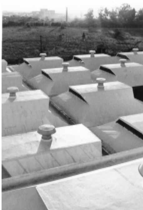
FIG.2 Indústrias Memphis, módulos de cobertura tronco-piramidais com iluminação e ventilação. Arquivo Equipe de Arquitetos.
