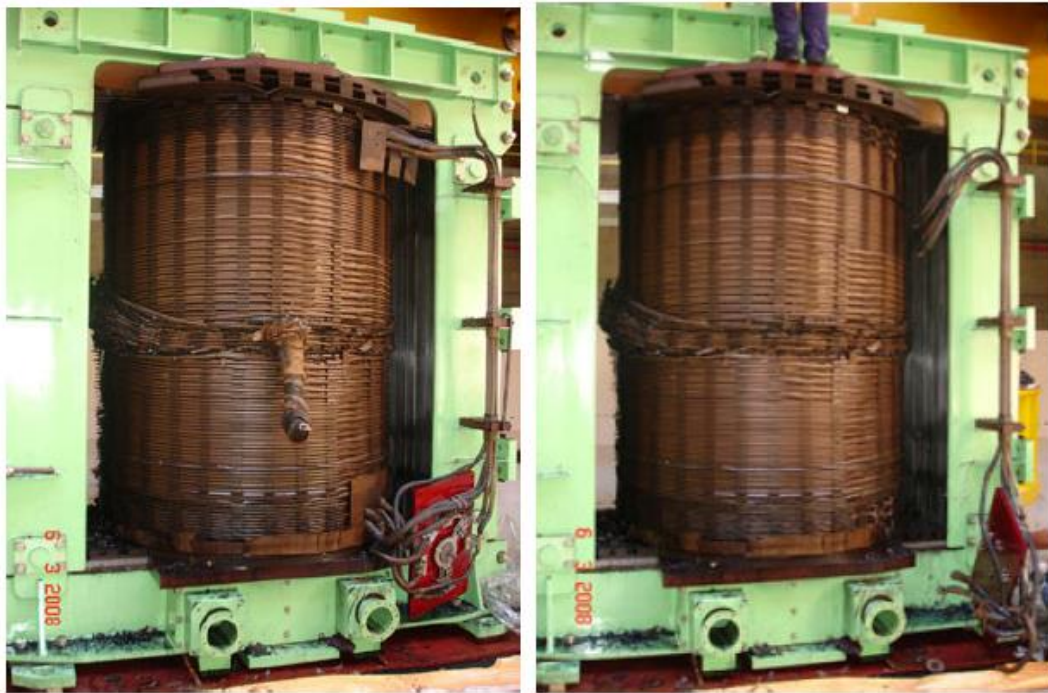
Figura 8 - Bobina danificada em decorrência a falha do isolamento
