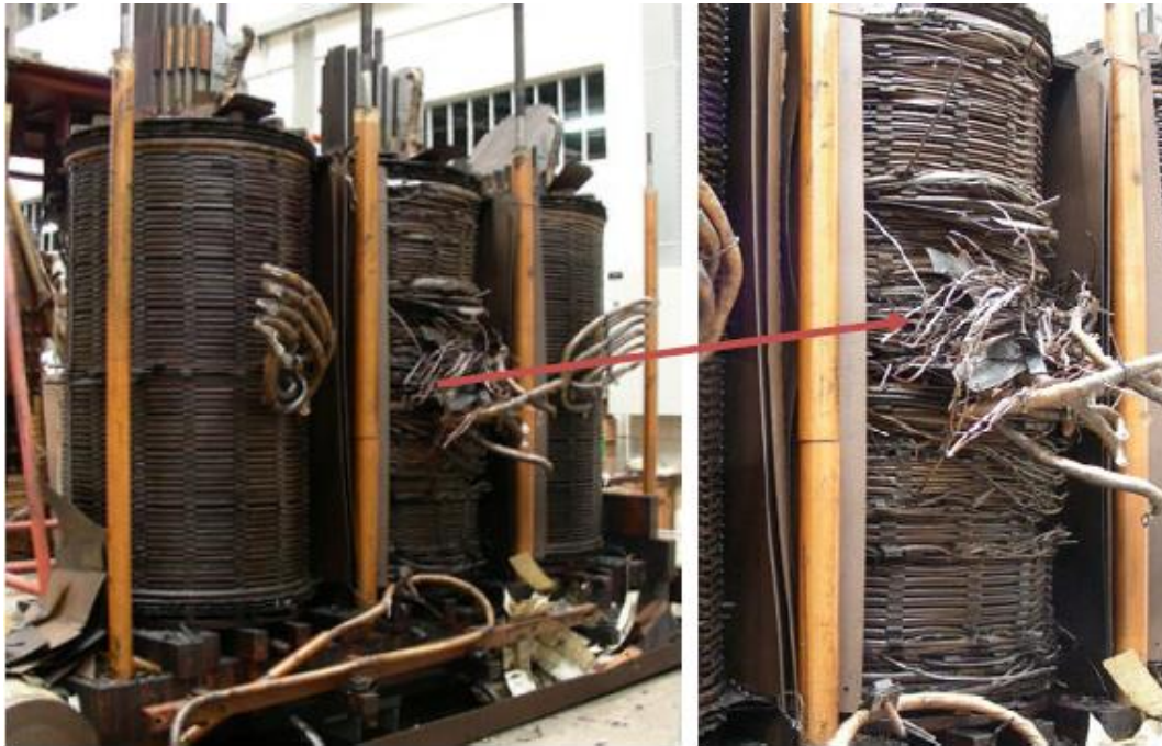
Figura 9 - Bobina danificada em decorrência a falha do isolamento
