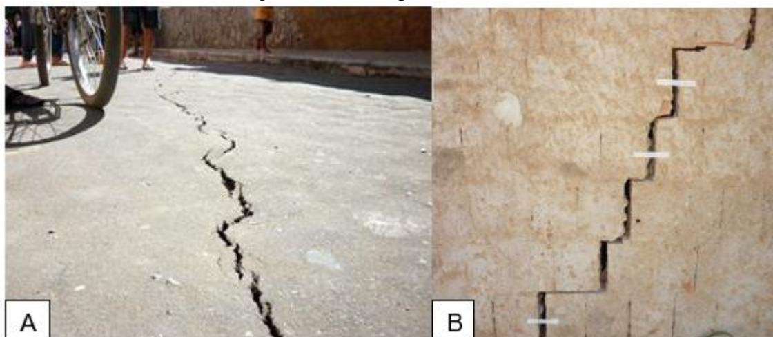
Imagem 15 - Exemplos de rachaduras
