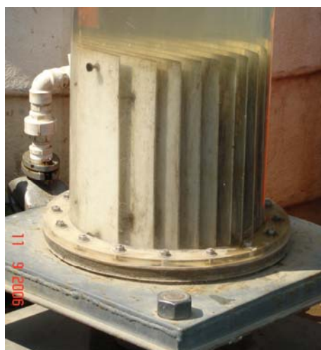
Figura 16. Direcionador de fluxo de placas paralelas instalado na saída da corrente de água tratada da coluna de flotação.
