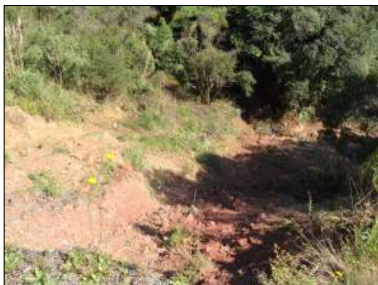
Figura 15: vista da ruptura, da rodovia (montante) para jusante (trabalho não publicado 28 )
