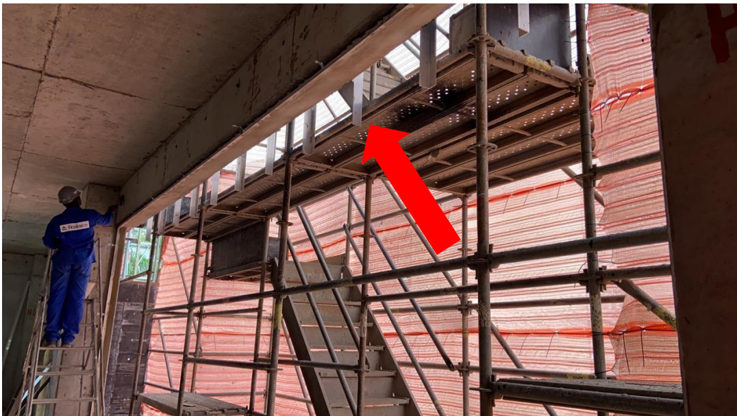
Figura 40 - Abertura onde não há fachada ventilada, perfis com sobra que irão ser cortado.
