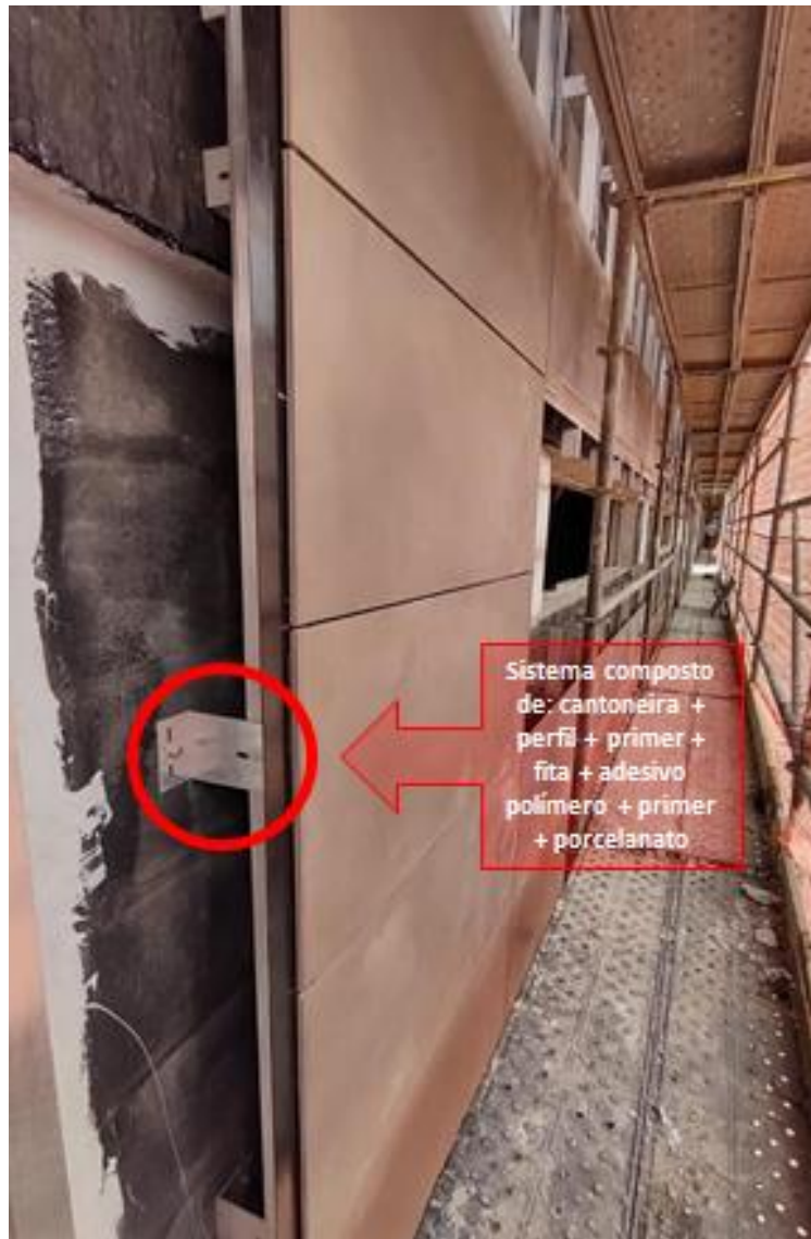
Figura 49 - Sistema com cantoneira, perfil metálico e porcelanato fixado com dupla face e adesivo.
