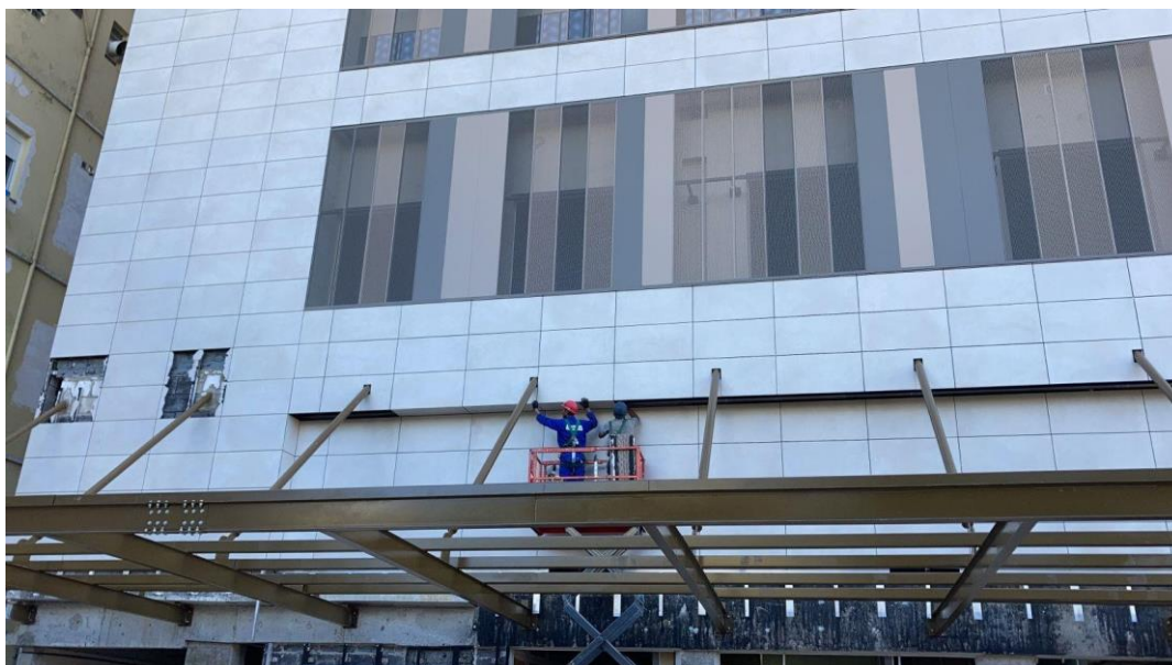
Figura 62 - Trecho da fachada Sudoeste após a estrutura da marquise estar finalizada e os arremates da fachada ventilada sendo executados.
