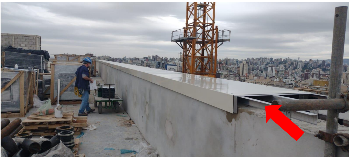
Figura 54 - Colocação de estruturas auxiliares na platibanda para fixação do rufo em alumínio.
