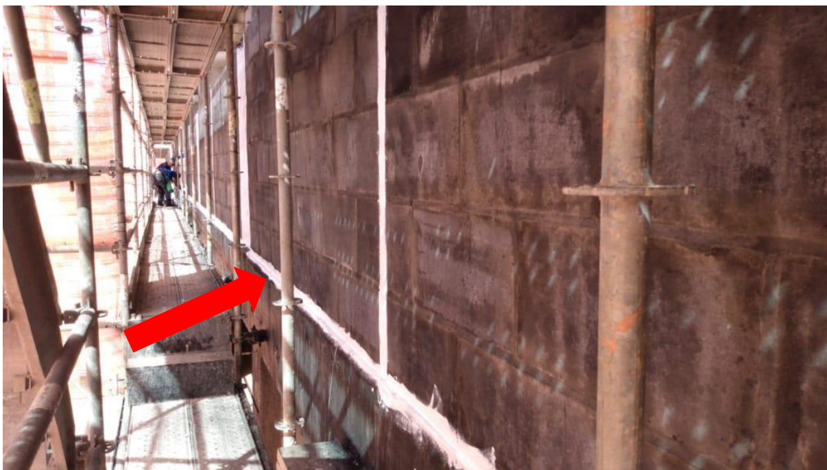
Figura 33 - Trecho da fachada impermeabilizada e com o gel selante nas juntas de alvenaria com estrutura de concreto armado.
