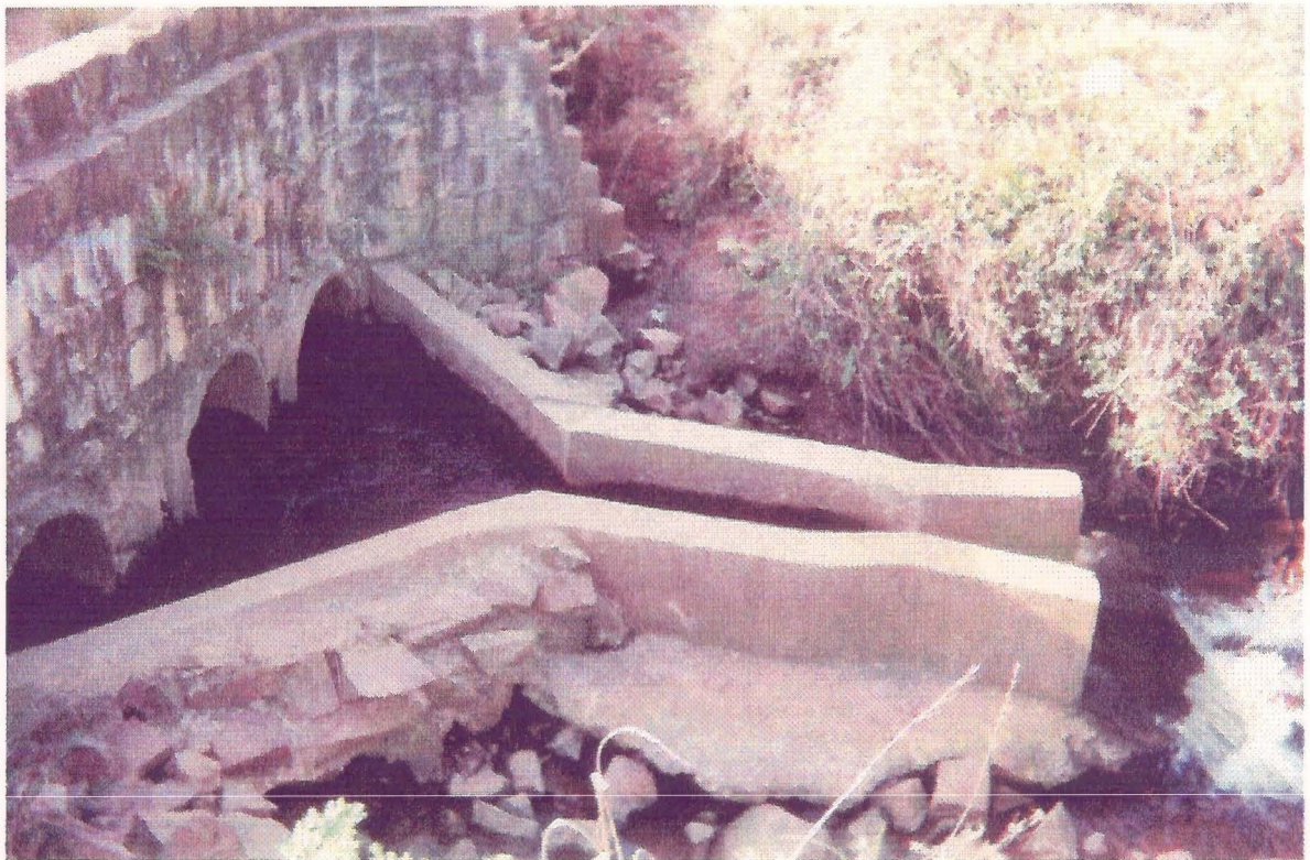
FIGURA 7 - Calha Parshall instalada na Microbacia Primavera (foto do autor).
