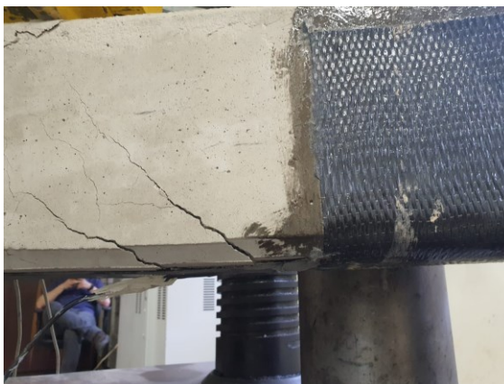
Figura 4.18 – Ruptura da seção transversal da viga VPU-2
