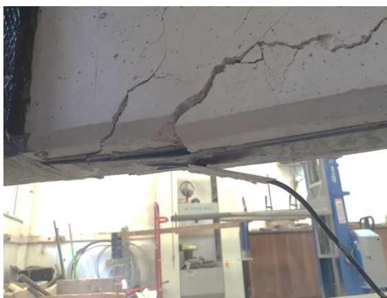
Figura 4.19 – Deslizamento do laminado do sistema de ancoragem da viga VPU-2
