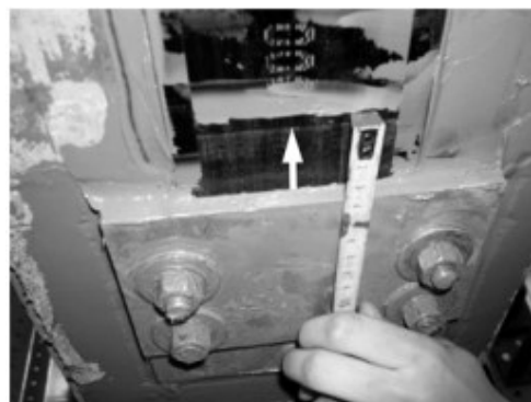
Figura 2.32 – Deslizamento do laminado do dispositivo de ancoragem durante o ensaio estático
