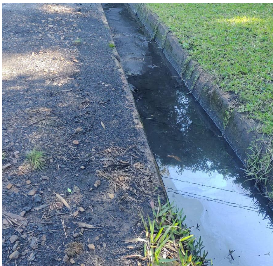
Figura 4 - Canaletas de concreto.
