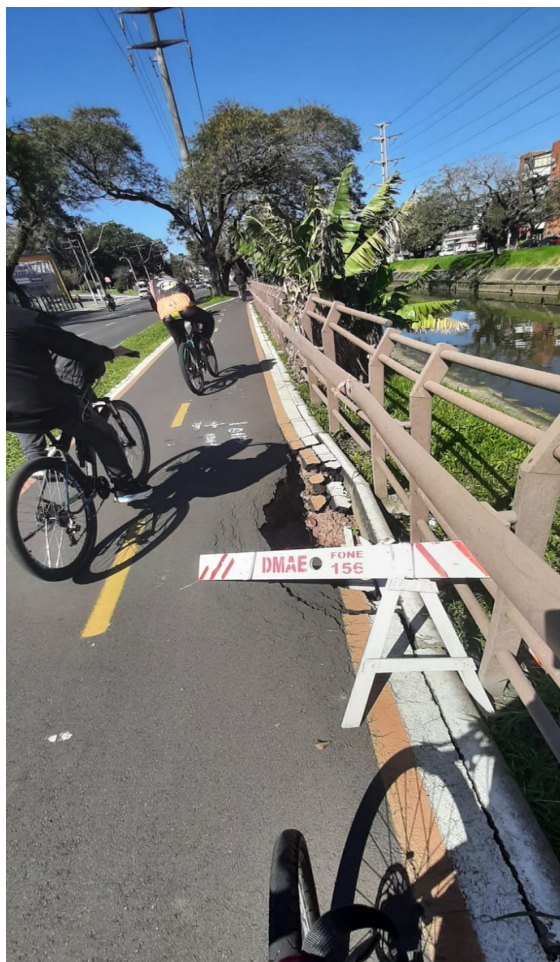
Figura 12: Buraco e deslizamento na Ciclovía da Avenida Ipiranga Fonte: A autora
