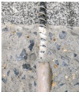
Figura 5.24 – Modo de falha C20-12B
