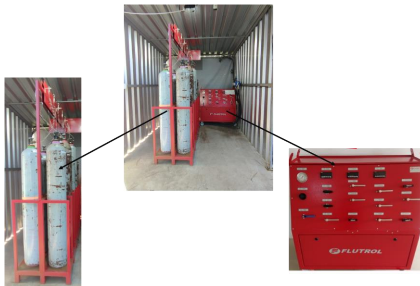
Figura 33 - Estrutura e Disposição dos Equipamentos de Pressurização no Local de Testes.
