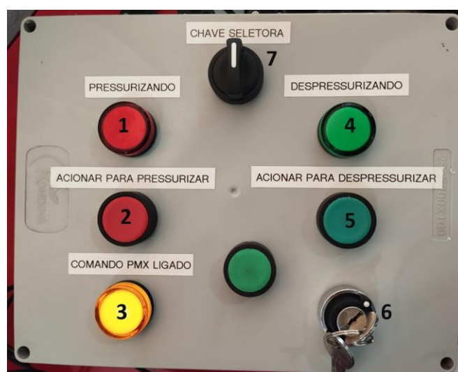
Figura 34 - Painel de Comando para Acionamento dos Solenóides e Controle da Pressurização e Despressurização das Amostras.
