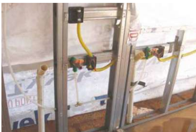
Figura 18: passagens das tubulações elétricas e hidráulicas no LSF
