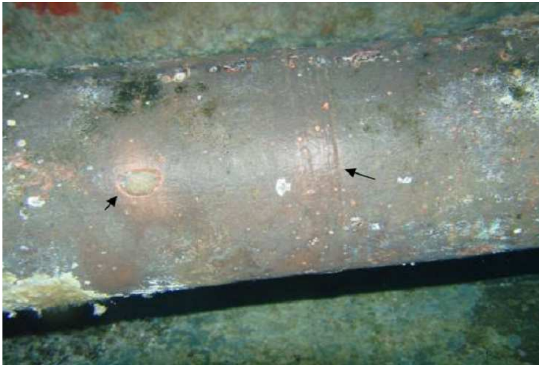
Figura 3.4 Foto da tubulação mostrando que não foi realizado esmerilhamento das soldas durante etapa de fabricação e a presença de incrustações.
