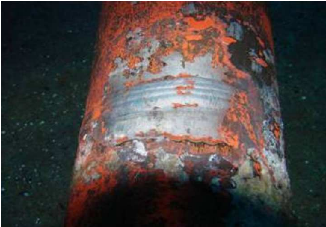
Figura 3.3 Foto da tubulação mostrando a ausência de revestimento na região da solda devido à deterioração.
