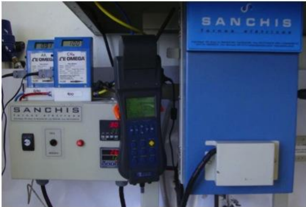
Figura 5.2. Equipamento para combustão do metano e análise dos gases de exaustão.
