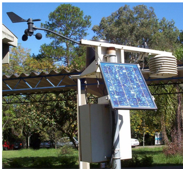
Figura 3.6. Estação meteorológica automática
