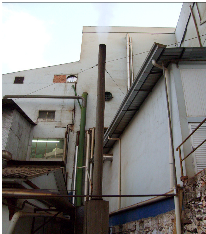
Figura 12 - Chaminé de exaustão da graxaria
