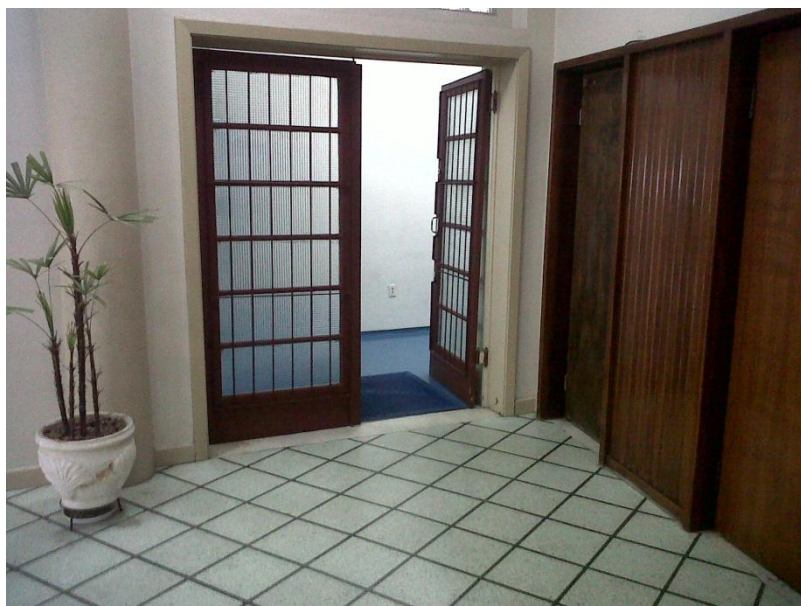
Figura 24 – Sentido não adequado de abertura da porta
