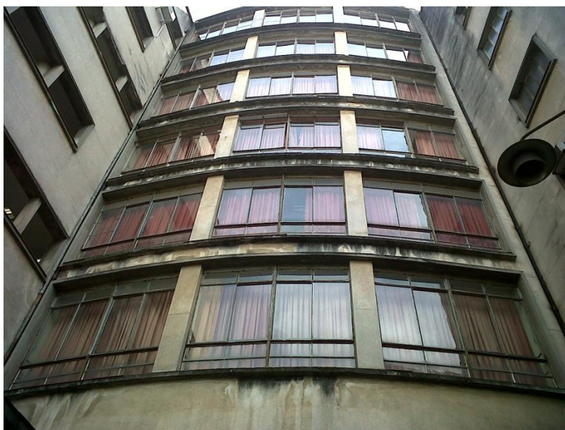
Figura 25 – Falta de isolamento vertical dos auditórios
