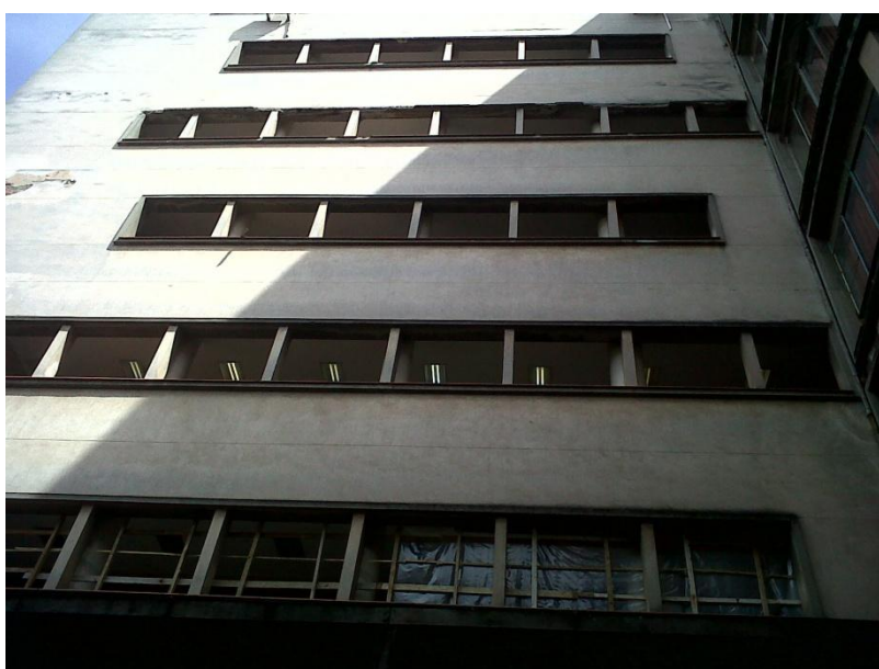
Figura 26 – Falta de isolamento horizontal dos auditórios com os corredores
