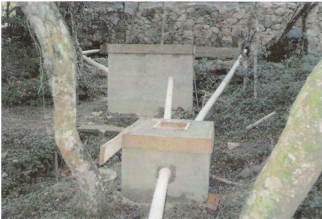
Figura 69: caixa de mistura das águas.
