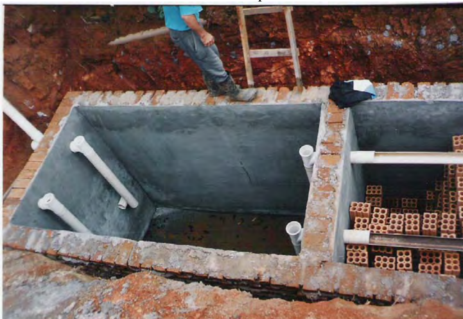
Figura 66: reator anaeróbio, em fase de construção, para o tratamento das águas negras do prédio do restaurante.
