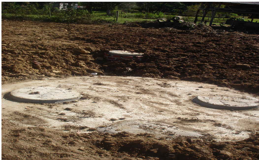
Figura 39: Estação de tratamento de esgoto sanitário, tipo Ralf, da Rua Ermindo Mayrer, em 06/05/2009 (Fonte: Prefeitura Municipal de Feliz)
