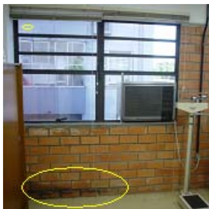
Figura 87: Alvenaria com umidade
