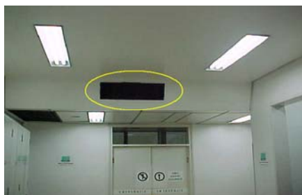
Figura 118: Saída do ar condicionado central – uma das fontes de ruído do ambiente
