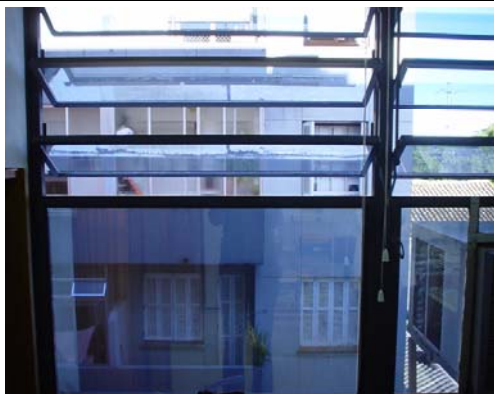
Figura 98: Janela da sala de enfermagem com película de proteção
