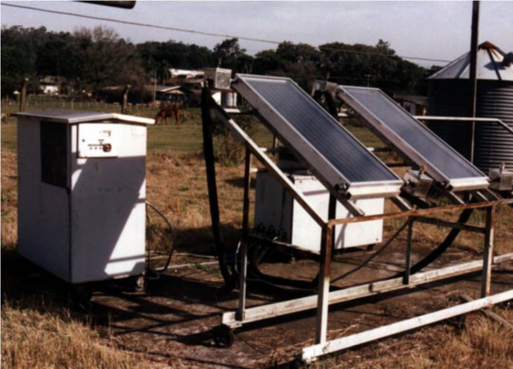
Figura 4.10- Coletores sob teste na bancada Aquatherm. O gabinete da esquerda é o sistema de refrigeração e o do fundo abriga os sistemas de aquecimento e circulação de água.
