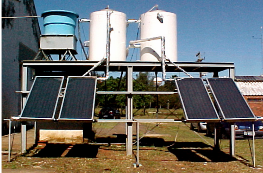
Figura 3.1 - Vista geral dos sistemas de aquecimento de água.
