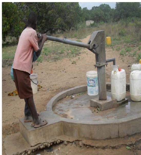
Figura 19 - Poço ou Furo protegido
