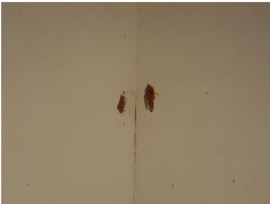
Figura 19 – Pontos de oxidação no revestimento de pasta de gesso
