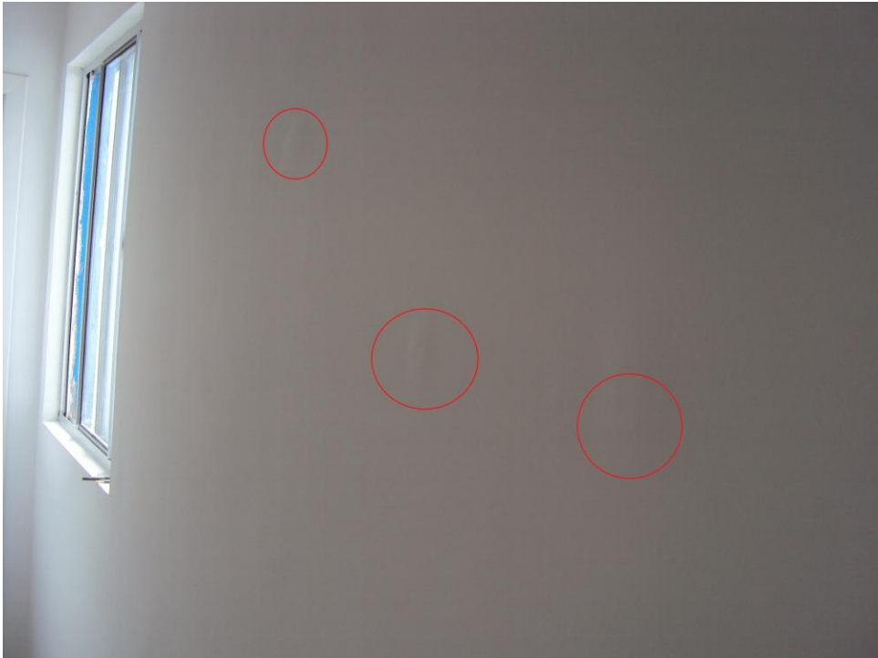
Figura 20 – Estufamentos no revestimento de pasta de gesso
