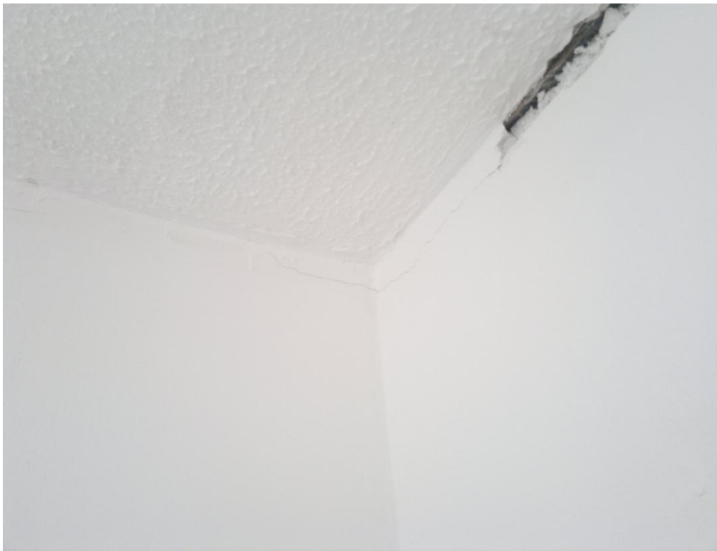
Figura 17 – Fissuras no revestimento de pasta de gesso junto à laje de cobertura
