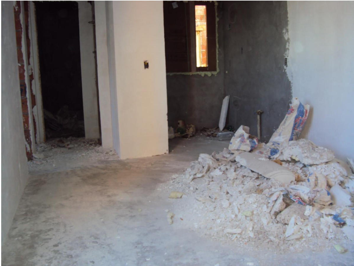
Figura 2 – Desperdício de material e formação de entulho
