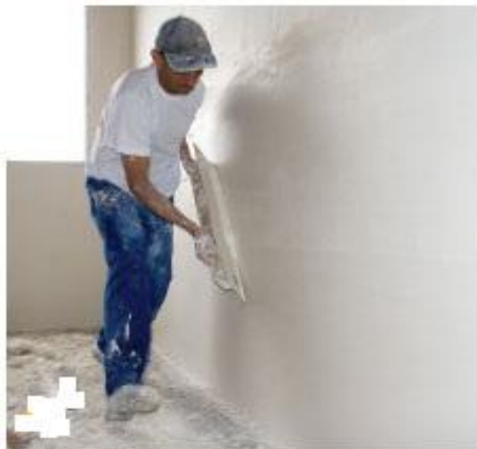
Figura 1 – Parede revestida com pasta de gesso
