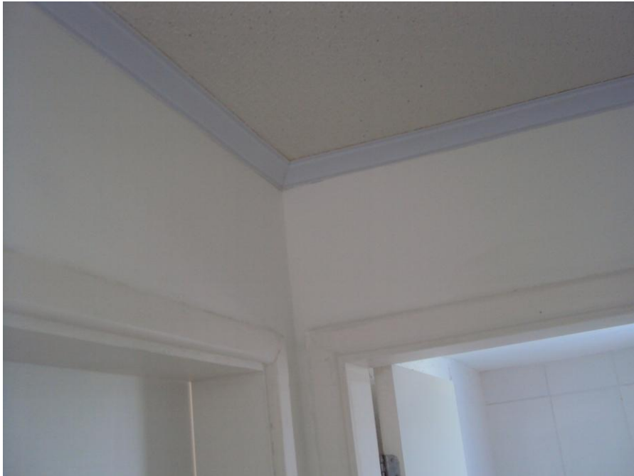
Figura 18 – Junta de movimentação, entre revestimento de pasta de gesso e laje, escondida por roda-forro
