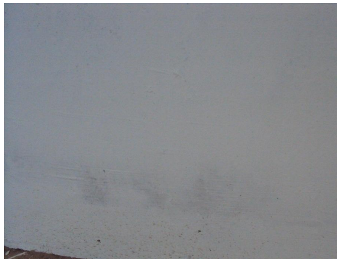
Figura 16 – Infiltração na parede de um apartamento térreo
