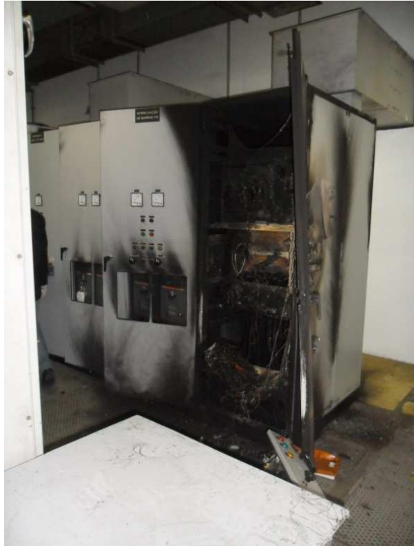
Figura 2: Foto do QGDF-31 após ocorrência do curto circuito (retirado de [8])
