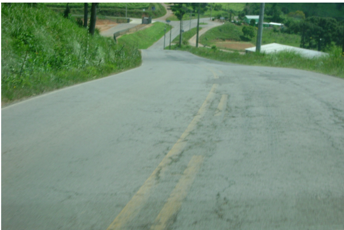
Foto 10 – Estrada entre Flores da Cunha e Nova Pádua: rachaduras na pista
