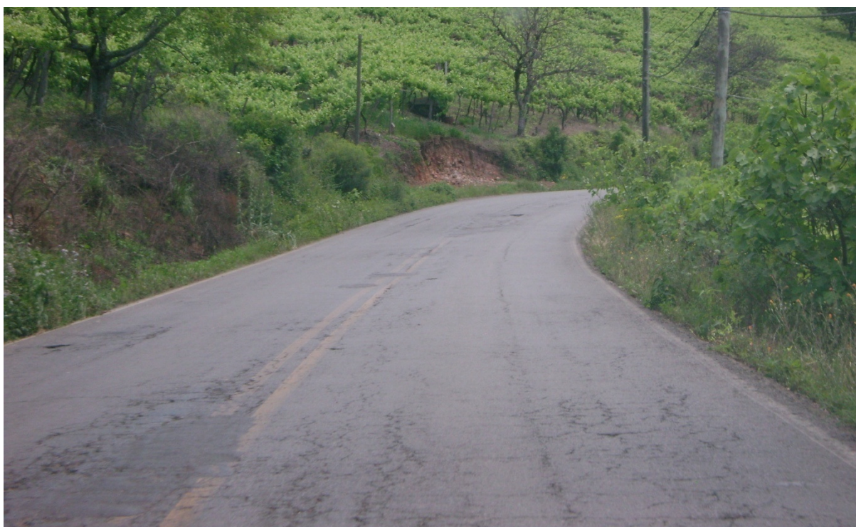
Foto 12 – Estrada entre Flores da Cunha e Nova Pádua: Falta de sinalização e acostamentos
