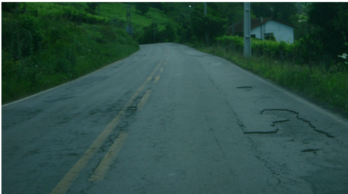
Foto 11 – Estrada entre Flores da Cunha e Nova Pádua: Buracos na pista
