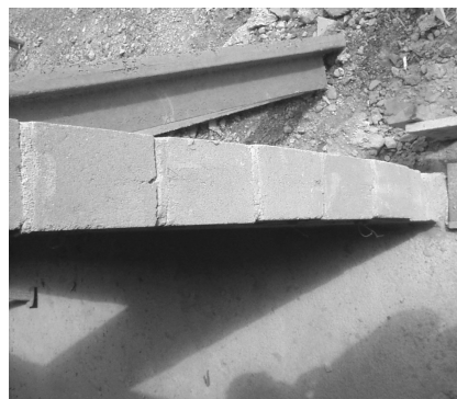
Figura 33: Parede fora do prumo
