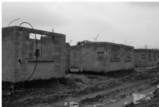
Figura 39: Presença de barro dificultando acessibilidade no canteiro do empreendimento Vivendas
