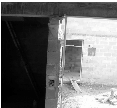
Figura 32: Local onde houve necessidade de enchimento para correção de medidas
