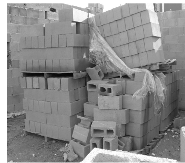
Figura 36: Armazenamento inadequado de paletes de blocos de concreto no canteiro
