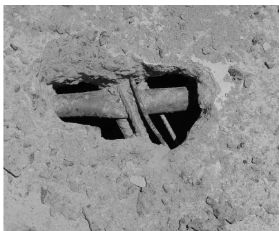
Figura 34: Tubulação elétrica comprimida pela ferragem no interior da laje pré-fabricada
