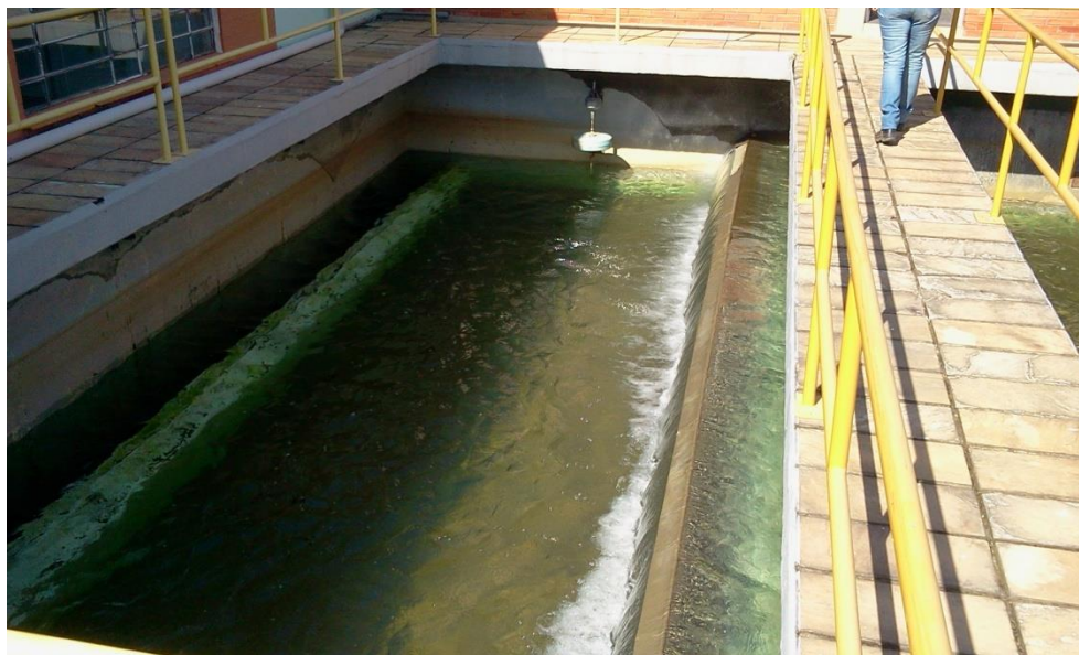
Figura 30 – Vista interna ETA do sistema Belém Novo.
