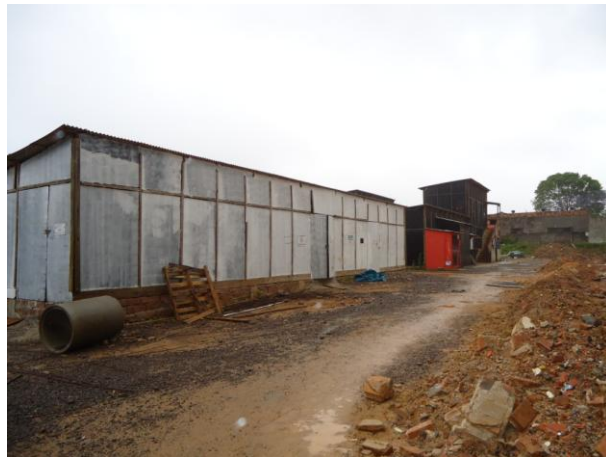
Figura 31 – Vista geral das áreas de vivência do canteiro de obras 6
