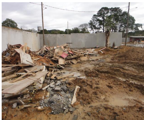
Figura 40 – Restos de materiais espalhados pelo canteiro de obras 8
