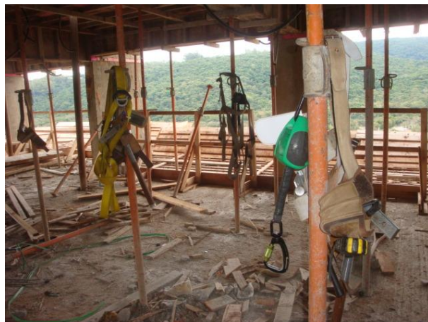
Figura 35 – Sujeira acumulada e EPI em local inapropriado no canteiro de obras 7
