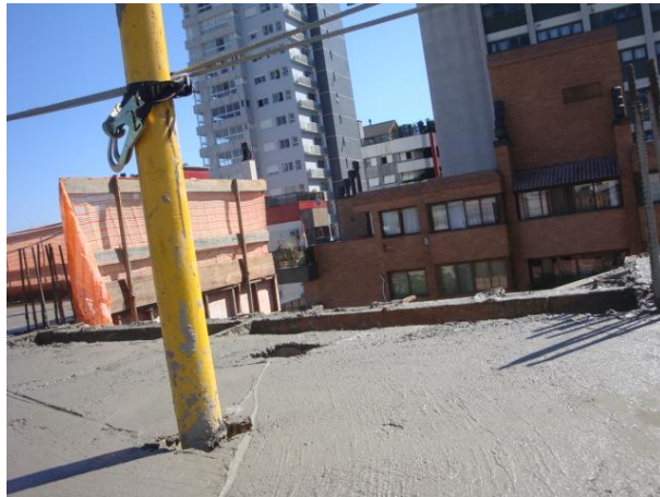
Figura 15 – Trecho sem proteção contra queda de pessoas e materiais na obra 3
