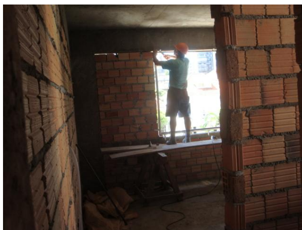
Figura 10 – Trabalhador sem EPI na obra 2
