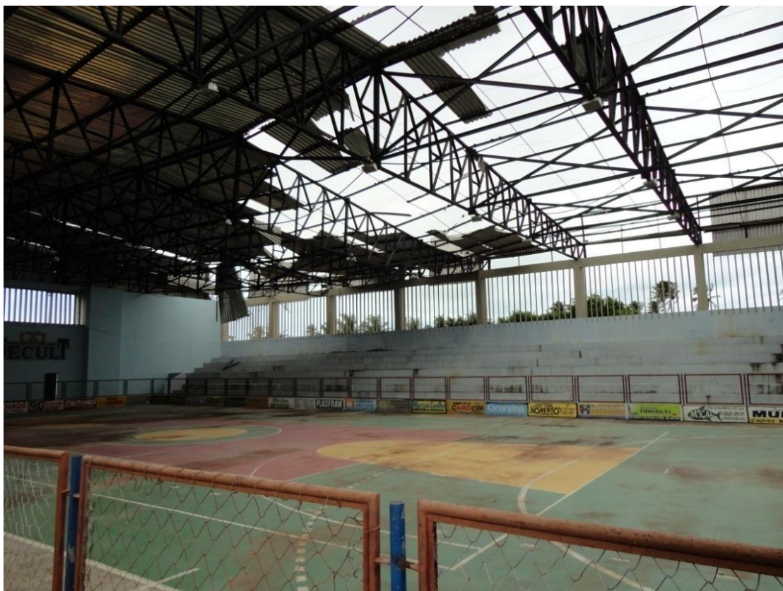
Figura 13: Estado de completo abandono do Ginásio Municipal do contexto litorâneo.
