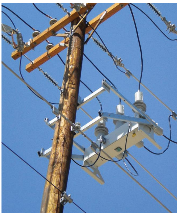
Figura 3 - Religador instalado em rede de distribuição aérea
