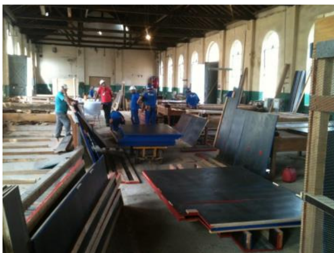
Figura 14 – Central de formas da obra estudada
