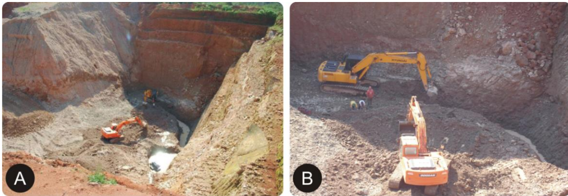
(A) Frente de extração de ágata; (B) Imagem ampliada do fundo da jazida.
