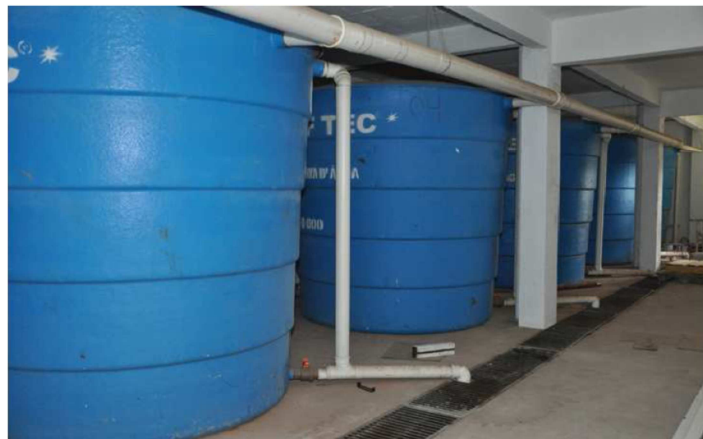
Figura 4.6 – Reservatórios do sistema de aproveitamento de águas pluviais do centro de convivência da UPF.
