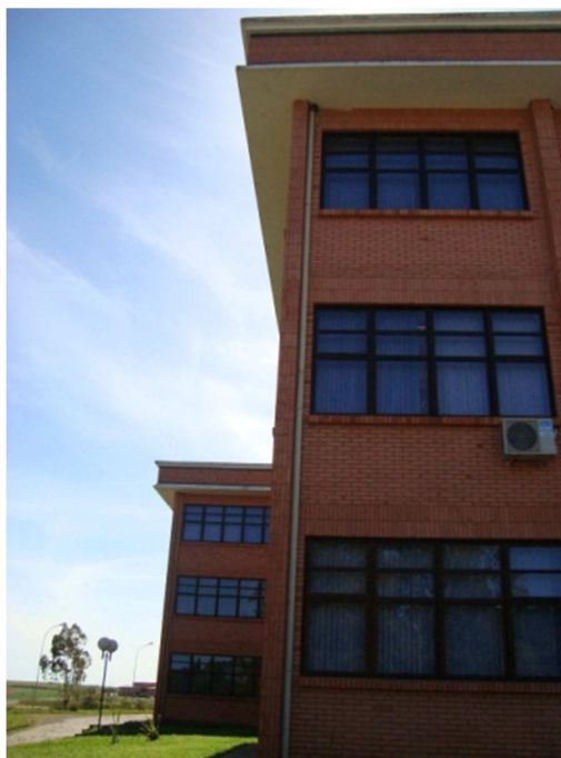
Figura 5.18 – Condutor vertical do sistema de águas pluviais na edificação piloto.
