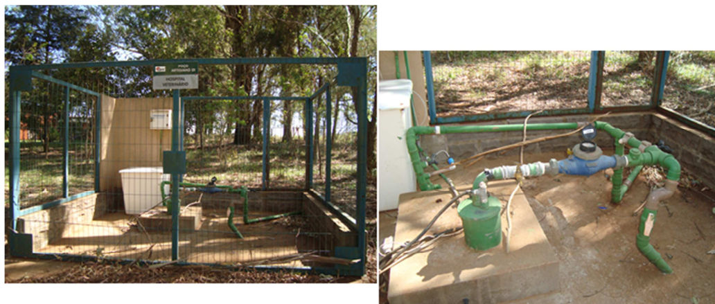
Figura 5.2 – Poço Artesiano PA-01 HV – UPF.
