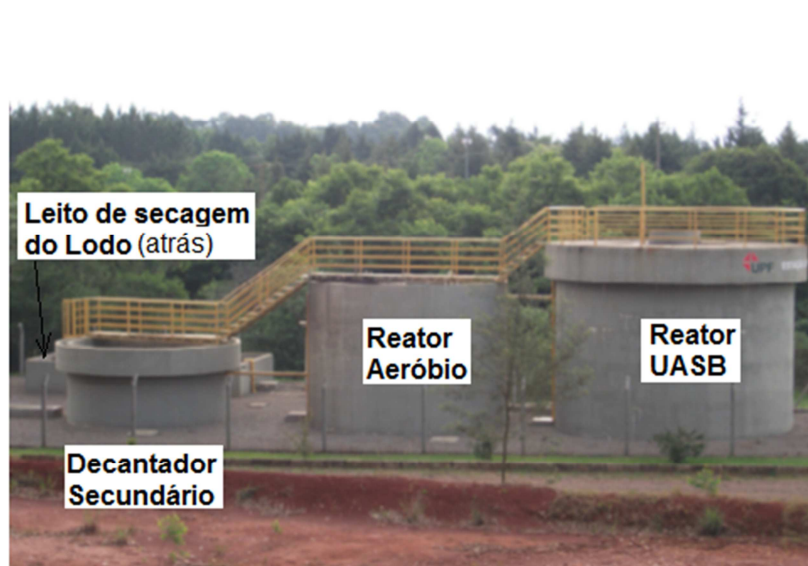
Figura 4.9 – Vista geral da ETE da UPF.
