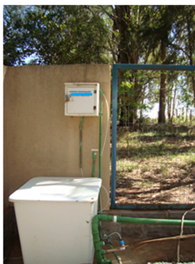
Figura 5.3 – Sistema de desinfecção por hipoclorito de sódio no Poço Artesiano PA-01 HV - UPF.
