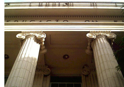
Figura 77 – Detalhe dos capitéis das colunas do pórtico de acesso do Instituto de Educação
